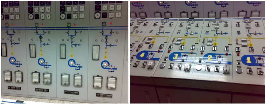
Figura 2. Paneles de control de la Casa de Máquinas, Planta Hidroeléctrica Chixoy
