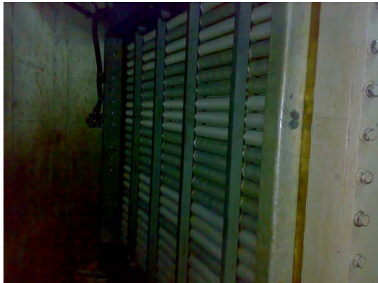
Figura 12. Sistema de enfriamiento de los generadores
