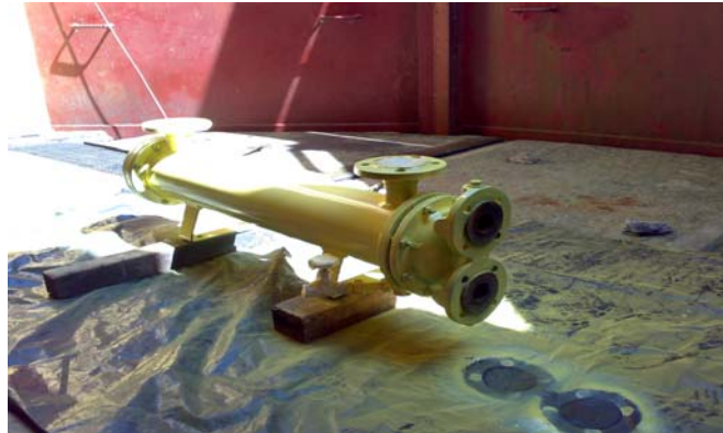
Figura 10. Tubería del sistema de enfriamiento de las turbinas
