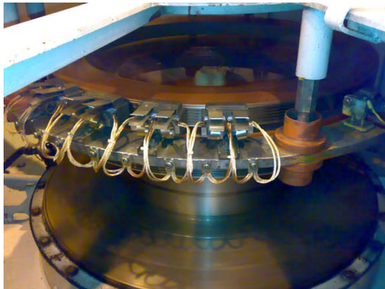
Figura 11. Parte interna del generador de la Planta Hidroeléctrica Chixoy
