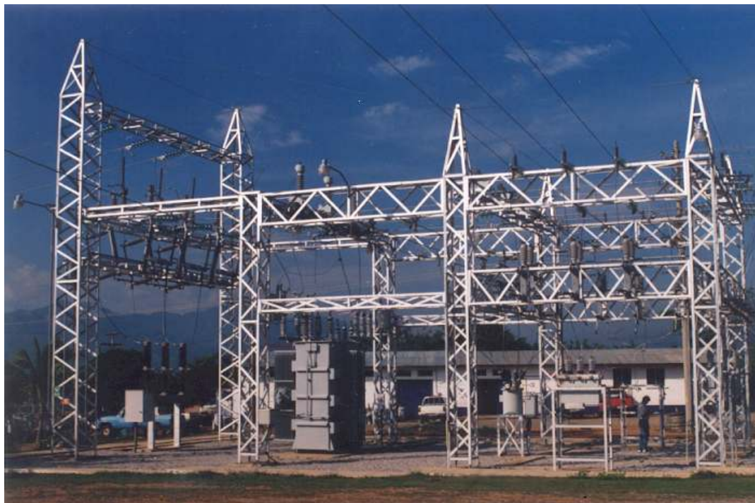
Figura 6. Subestación Shoropin en Chiquimula
