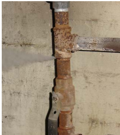
Figura 2. Tubería dañada y fuga de vapor
