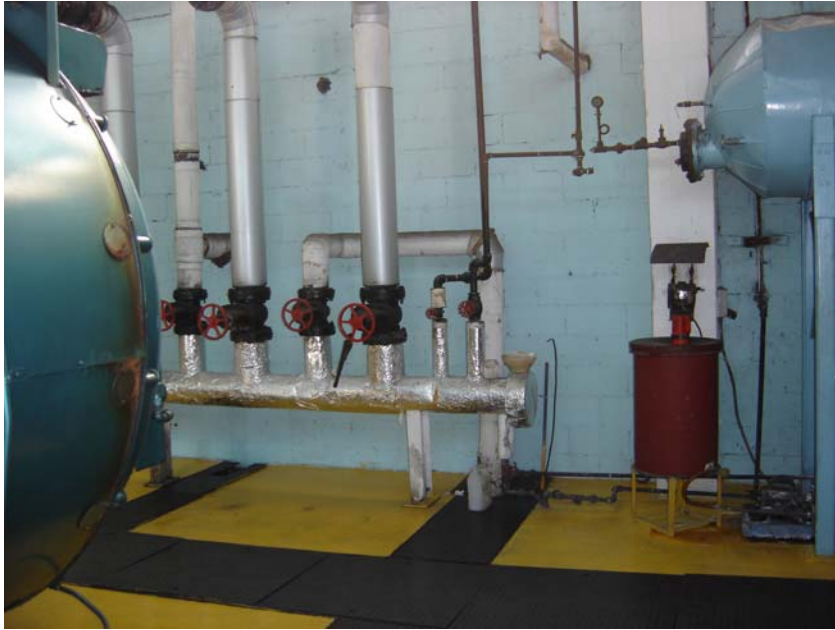
Figura 24. Múltiple de admisión en cuarto de calderas
