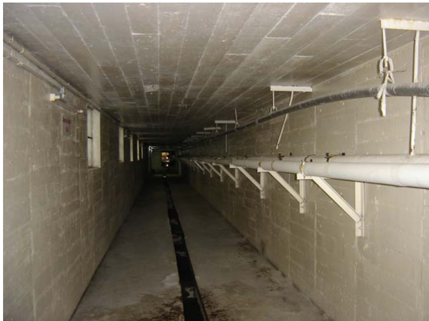
Figura 23. Tubería de vapor con material aislante en túnel de distribución de vapor del Hospital Roosevelt
