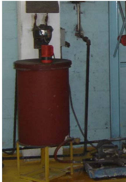
Figura 10. Tanque de suministro químico
