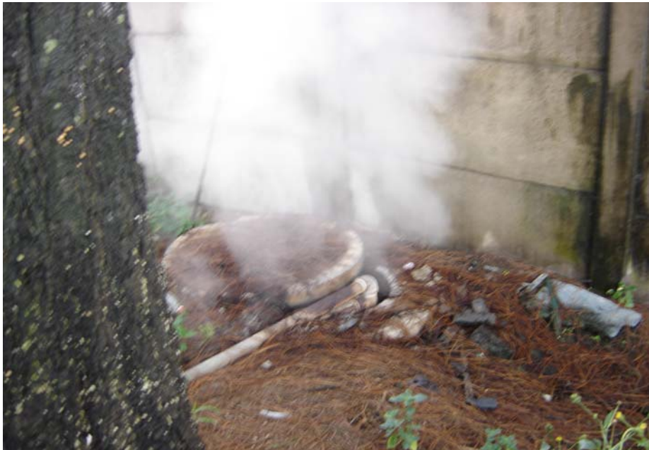
Figura 25. Desperdicio de condensado, viene de rebalse del tanque de alimentación
