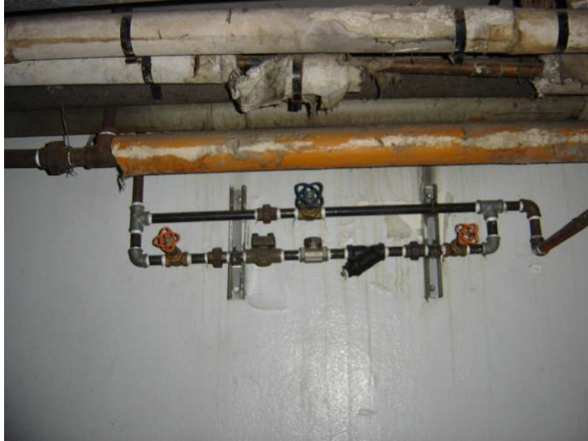
Figura 22. Tubería de vapor en malas condiciones y by-pass
