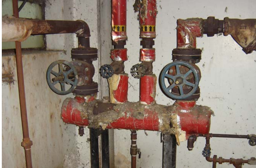
Figura 3. Aislamiento térmico dañado
