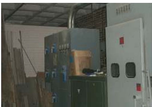
C. Trafo de distribución núm. 45 (3x50 kV, sobre el suelo) del edificio de biblioteca.
