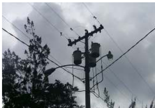
B. Trafo de distribución núm. 47 (3x25 kv, sobre poste) del edificio S-7.
