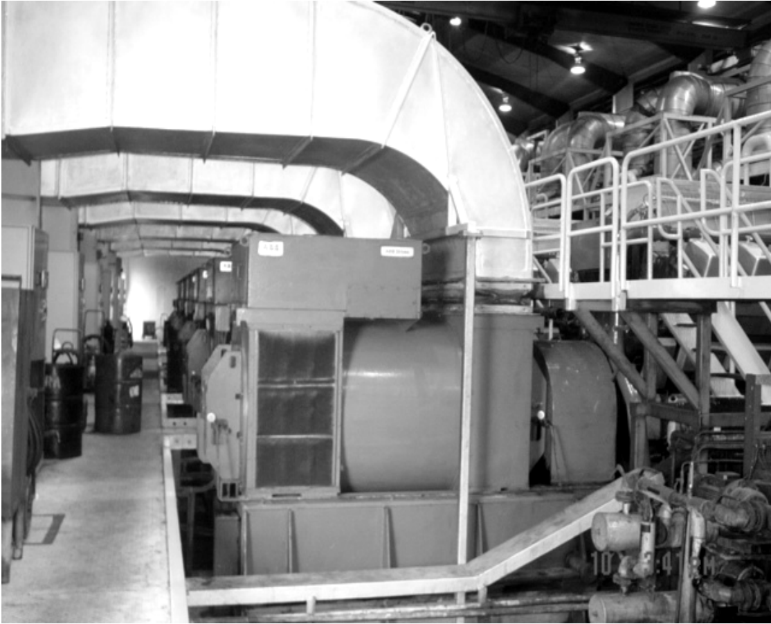
Figura 30. Vista completa del generador bajo prueba y el interior de la barcaza.
