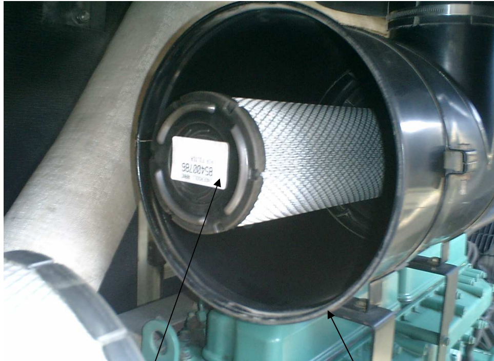
Figura 29. Revisión de filtros de admisión de aire
