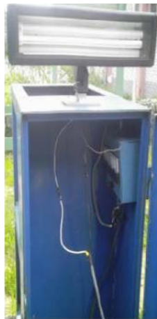
Figura 11. Cabina de medidores eléctricos
