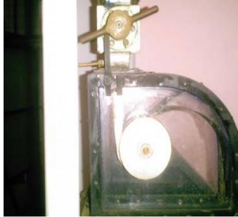
Figura 17. Chorro y purga manómetro 1
