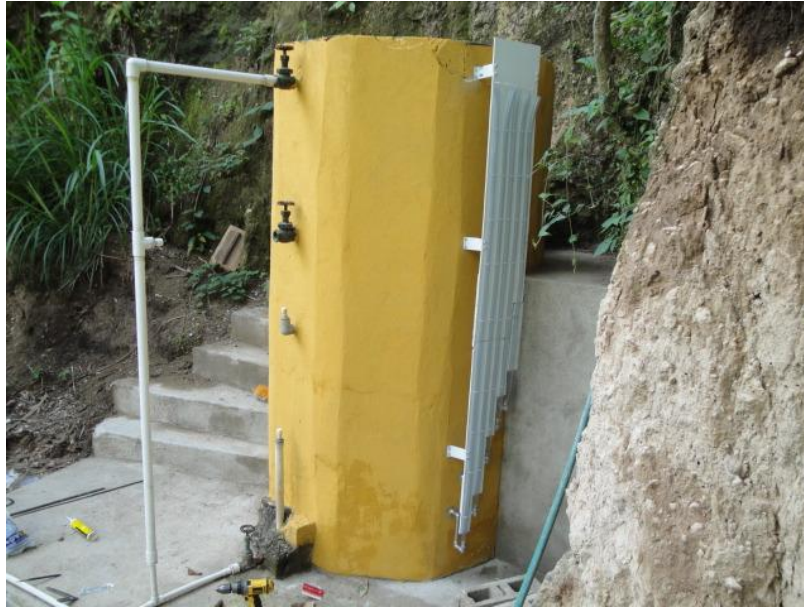
Figura 18. Vista del estado físico del filtro al final de la investigación
