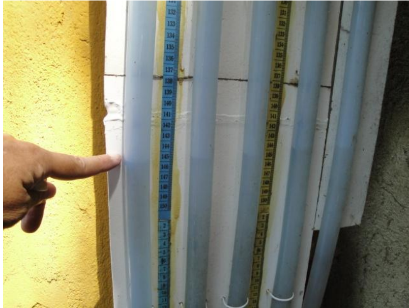
Figura 15. Piezómetro múltiple para evaluar la pérdida de carga
