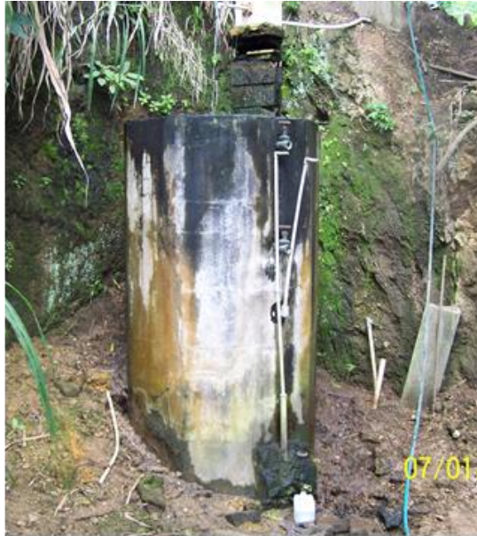
Figura 8. Vista del estado físico del filtro lento al inicio de la investigación
