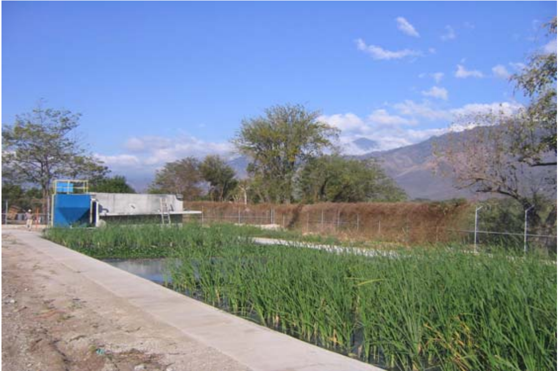
Figura 133. Planta de tratamiento de agua
