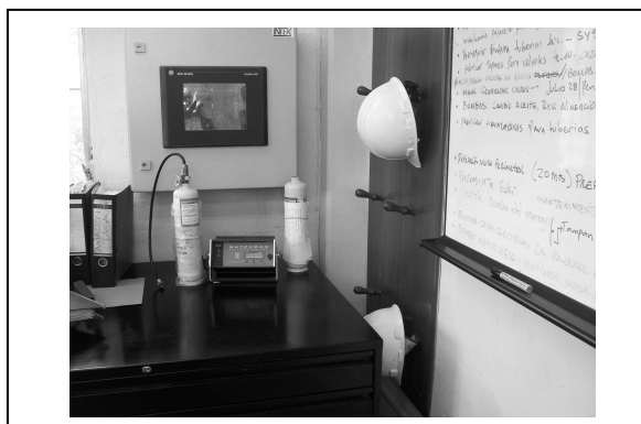
Figura 31 Localización de dispositivos de control de gases
