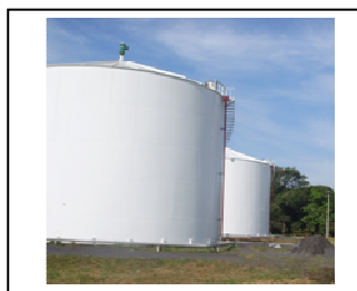
Figura 15 Tanque para almacenamiento de combustible.
