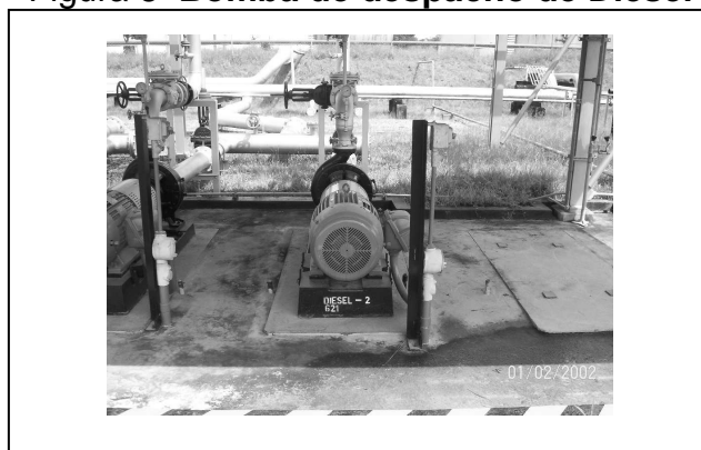
Figura 8 Bomba de despacho de Diesel
