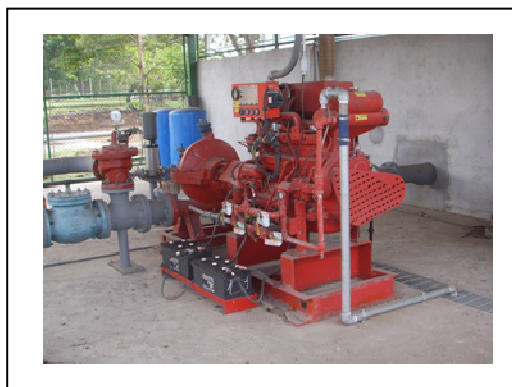
Figura 14 Motor del sistema contra incendios.
