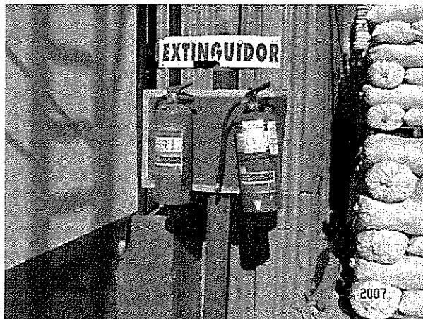
Figura 32. Extintores contra incendios.
