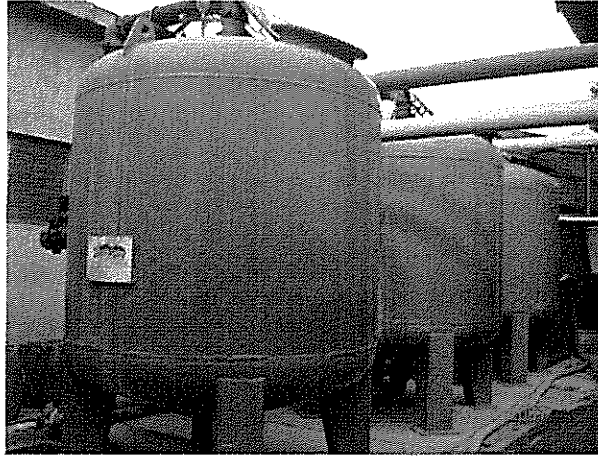
Figura 24. Filtros de arena verticales.
