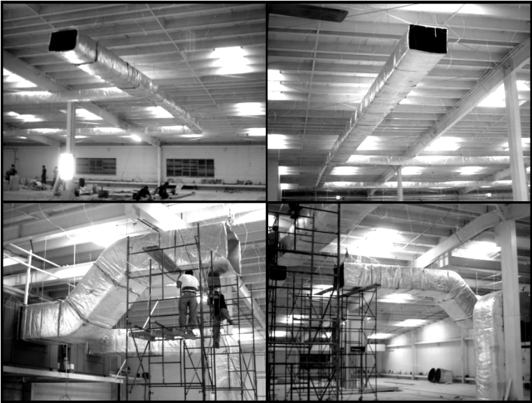
Figura 50. Fotografías de la parte final de la instalación del sistema # 3
