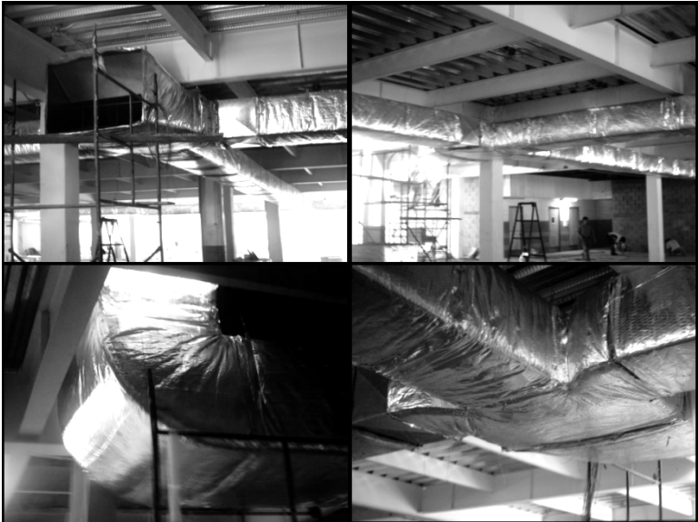
Figura 43. Fotografías del acople de ductería a la unidad # 1
