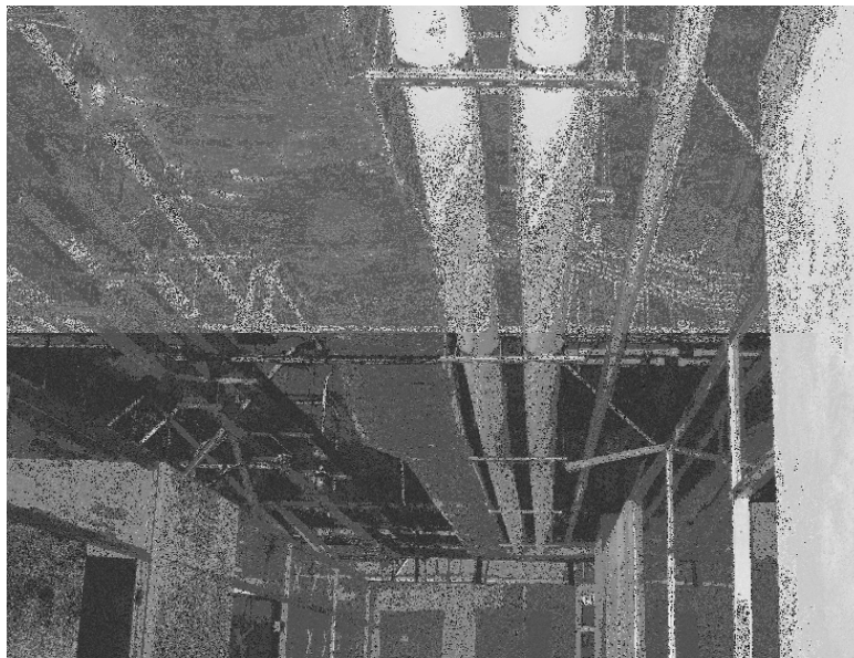
Figura 35. Soportes dentro del edificio para sistemas de tubería \text{Ø } 3 "
