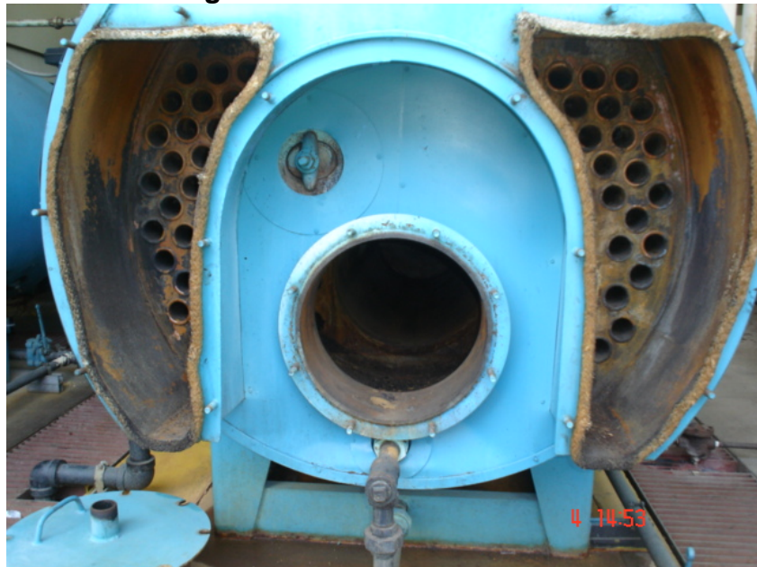
Figura 18 Tubos de la caldera
