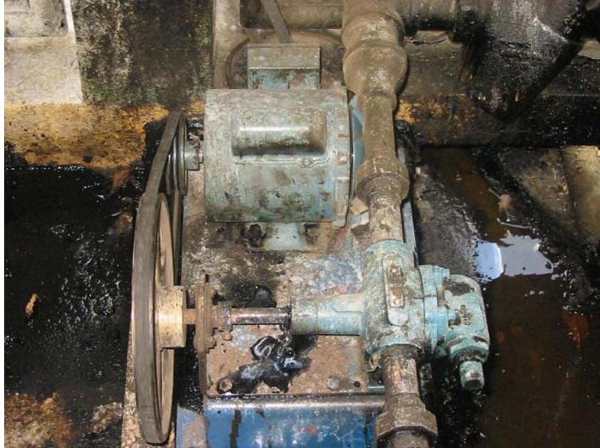
Figura 8 Bomba de suministro de combustible
