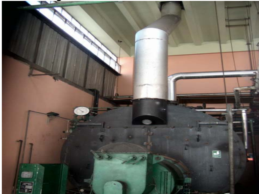
Figura 25 Chimenea de una caldera
