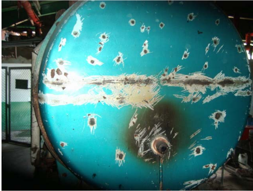
Figura 26 Superficie exterior de una caldera
