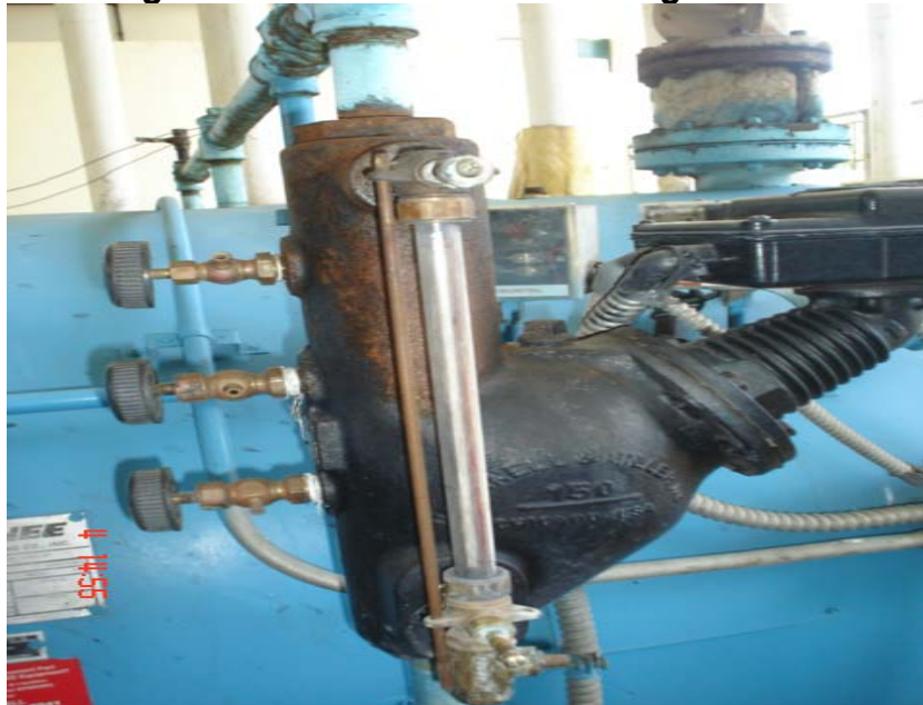
Figura 10 Medidor del nivel de agua
