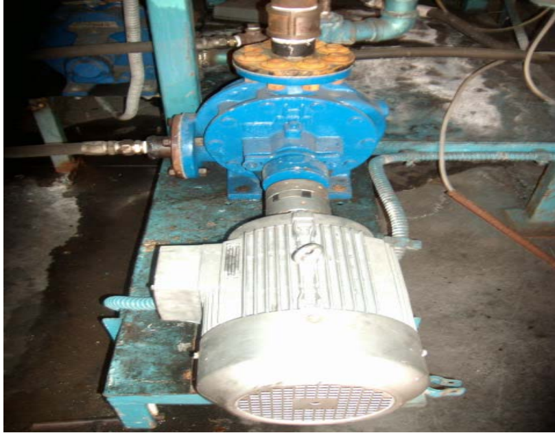
Figura 32 Bomba tipo turbina acoplada a un motor eléctrico
