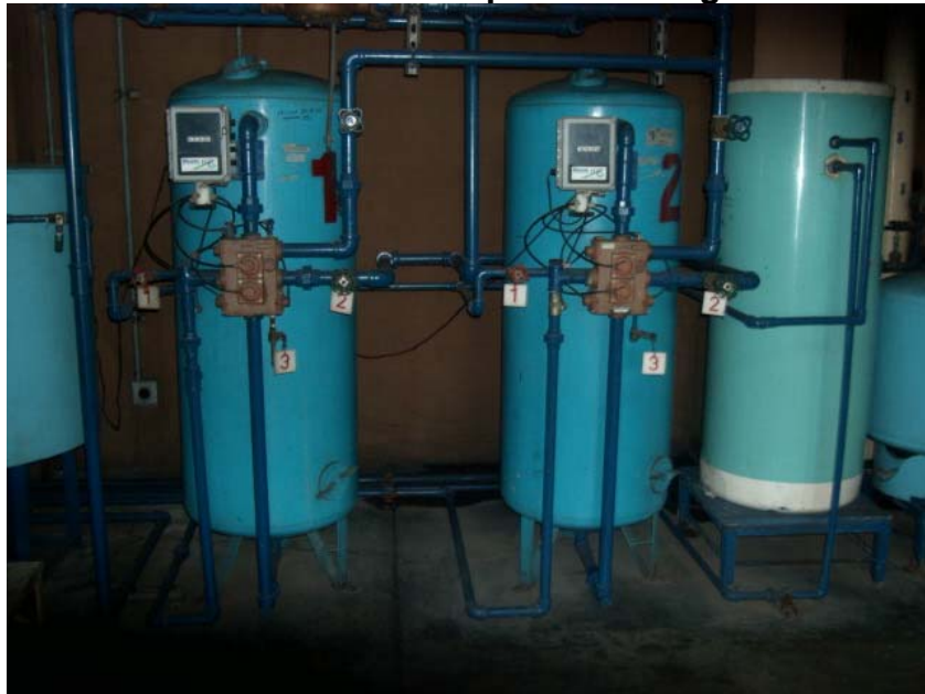
Figura 21 Sistema de tratamiento químico del agua de alimentación
