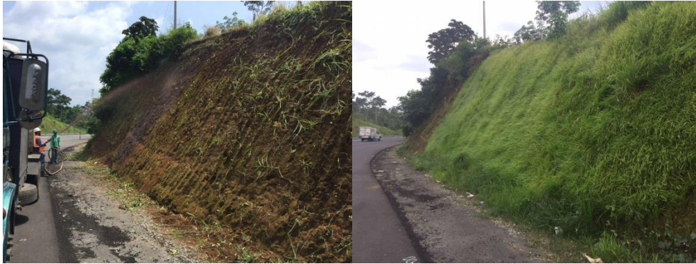
Figura 1. Control de erosión por medio del sistema de hidrosiembra con mulch de refinación térmica y grama perenne.
