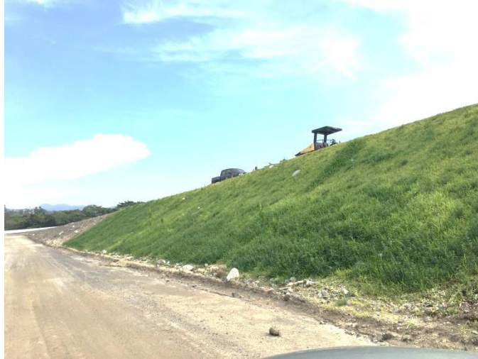
Figura 8. Talud de relleno relación 1:1, 35 días luego de su aplicación.
