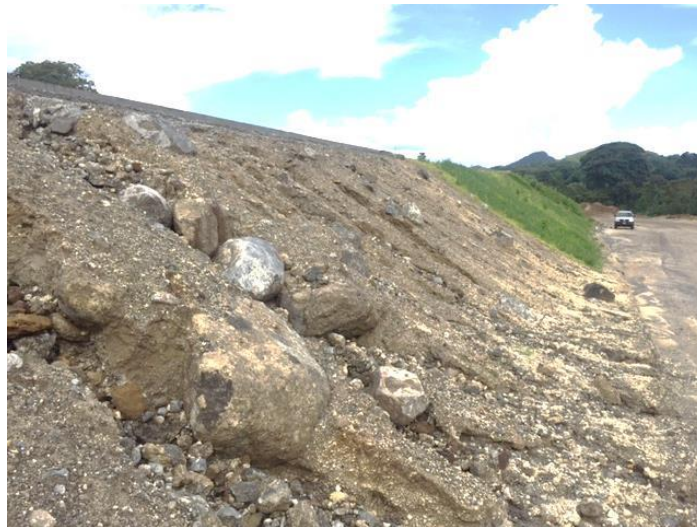
Figura 9. Talud de corte relación 1:1, si cubierta vegetal con una significativa degradación del suelo.
