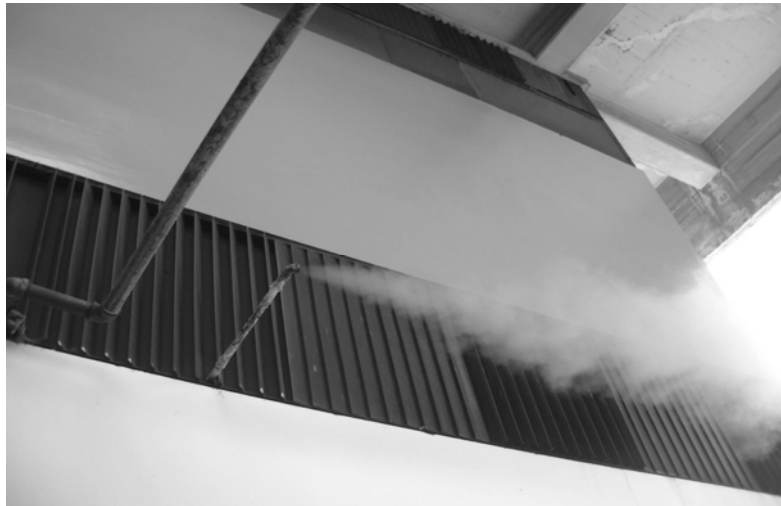
Figura 20. Escape de vapor desde el tanque de condensado
