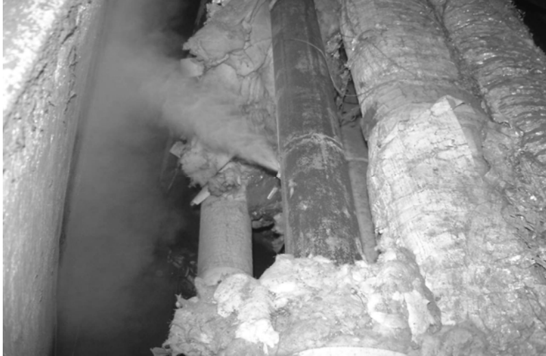
Figura 22. Tubería y aislamiento en mal estado en interior del túnel
