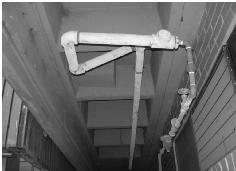
Figura 21. Tubería al final de línea en maternidad
