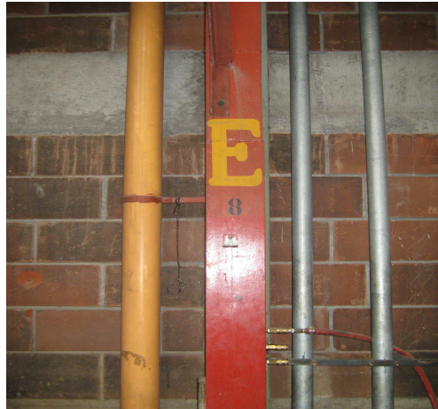
Figura 47. Faltante de extintores
