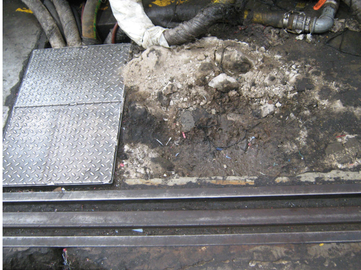
Figura 44. Piso en mal estado
