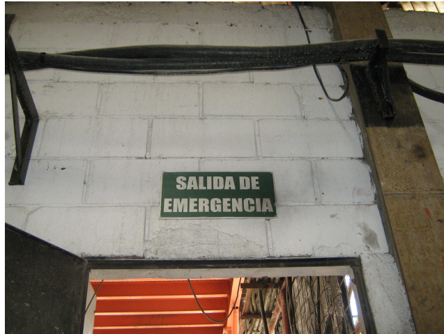
Figura 46. Salida de emergencia
