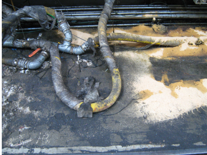
Figura 45. Aceite en el piso
