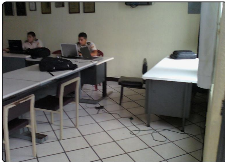
Figura 6. Conexión eléctrica del salón utilizado en el proceso de capacitación
