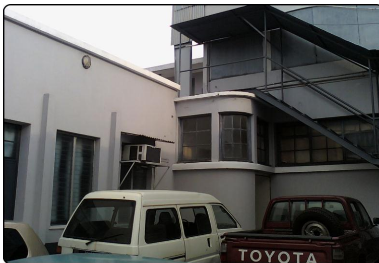
Figura 7. Aire acondicionado del salón utilizado en el proceso de capacitación
