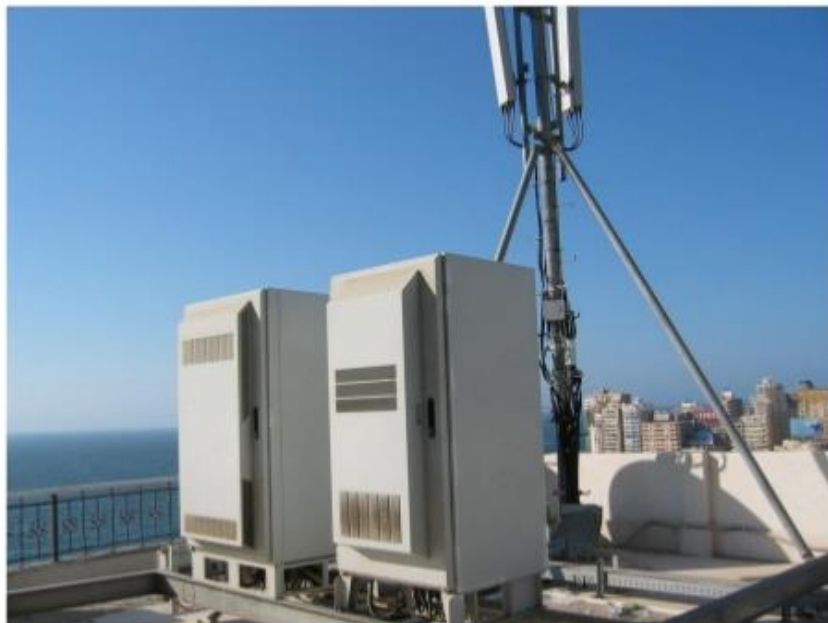
Figura 2. Estación base (BTS)
