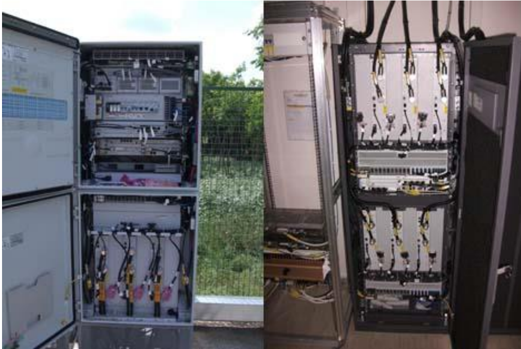
Figura 6. Componentes estación base
