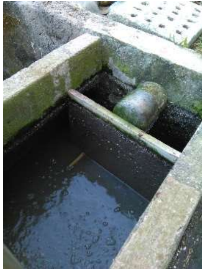
Figura 19. Cámara de entrada del sistema
