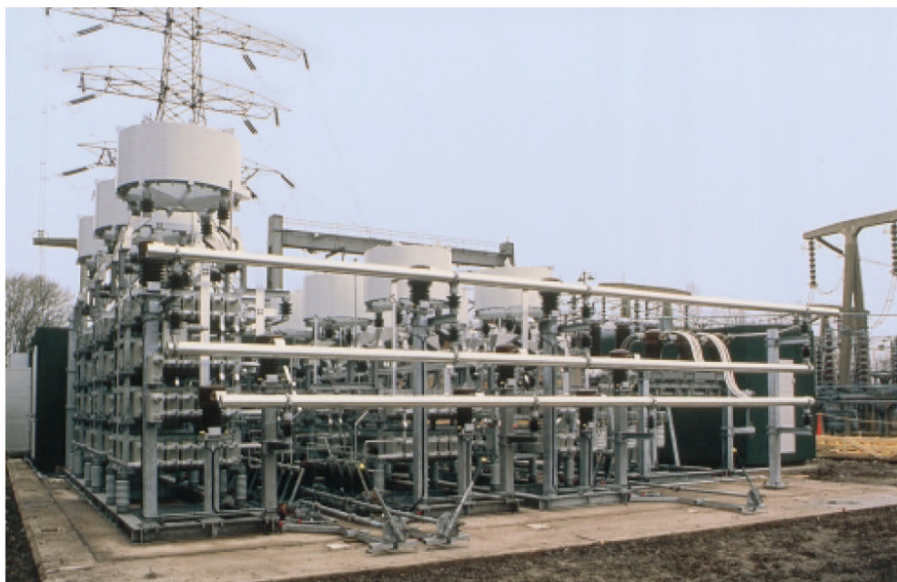
Figura 83 Compensador estático de potencia reactiva, desplazable, en la subestación de NGC en Penn (Gran Bretaña).
