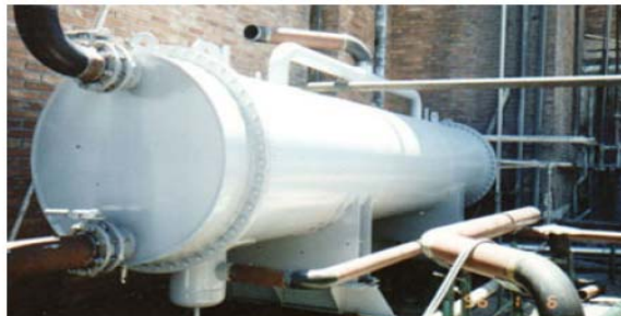
Figura 10. Condensador enfriado por agua
