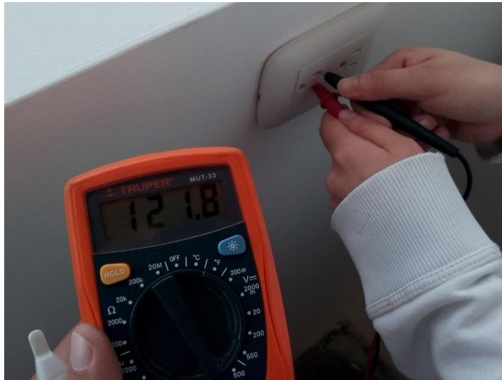
Figura 125. Medición de voltaje en cada tomacorriente
