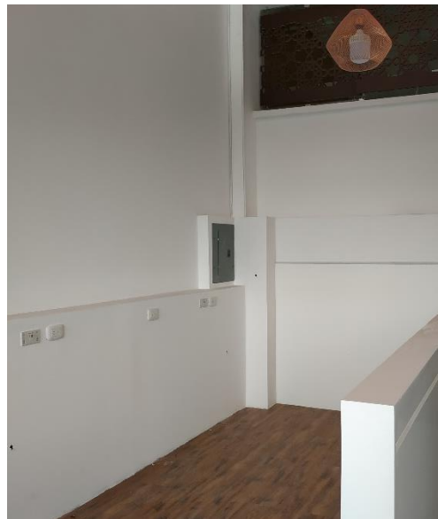
Figura 128. Tomacorrientes y puntos de red distribuidos en el laboratorio
