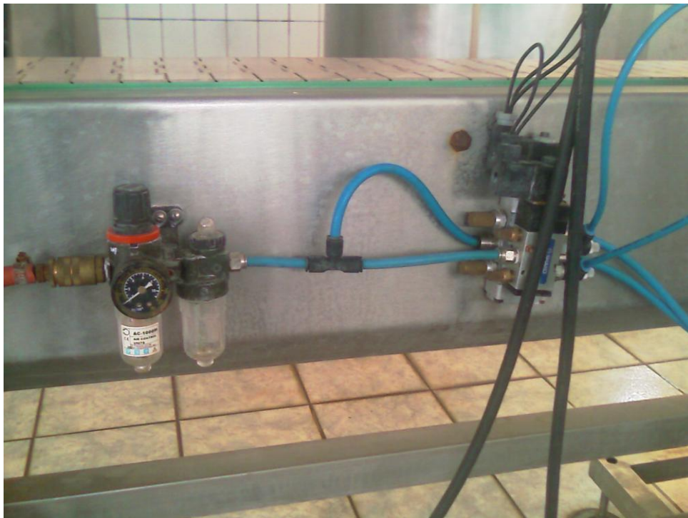
Figura 5. Vista del sistema neumático.
