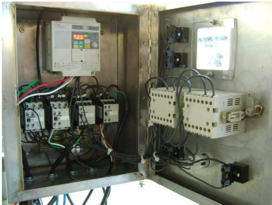
Figura 3. Vista interior de las conexiones eléctricas del panel de control.
