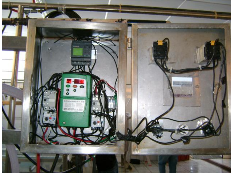
Figura 7. Conexiones internas del sistema eléctrico.
