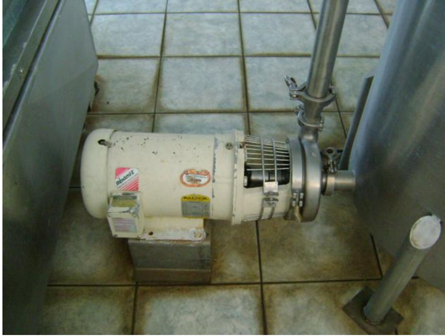
Figura 6. Sistema hidráulico de la máquina llenadora.
