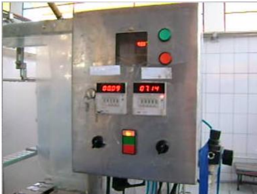
Figura 2. Vista exterior del PLC de la máquina lavadora.
