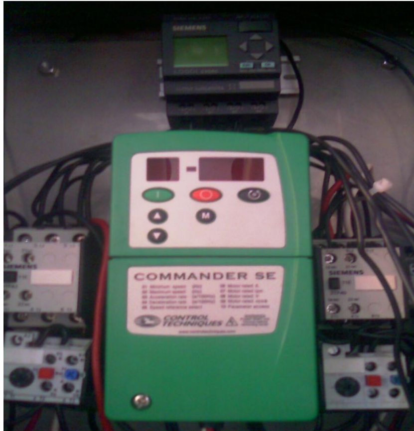
Figura 8. Vista interna del PLC.
