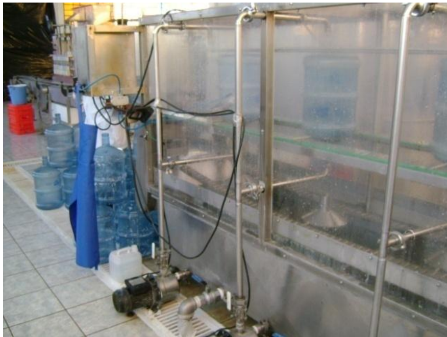
Figura 4. Bombas y boquillas del sistema de lavado.
