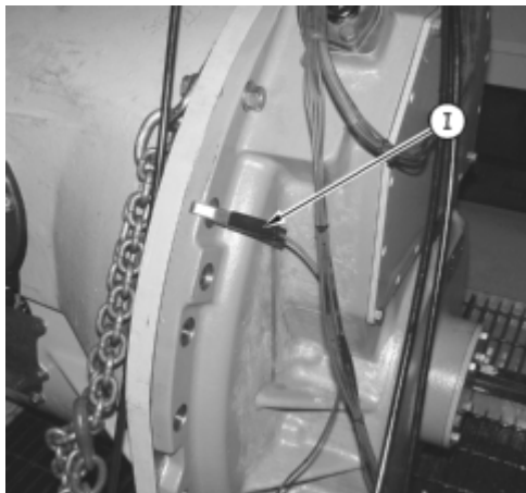
Figura 53. Conexión de sensor eléctrico
