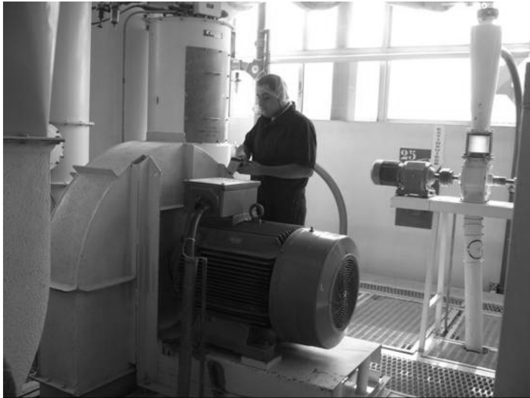
Figura 10. Toma de temperatura de motor eléctrico
