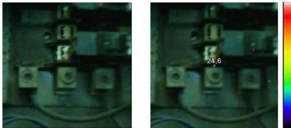
Figura 20. Termografía contador No.2
