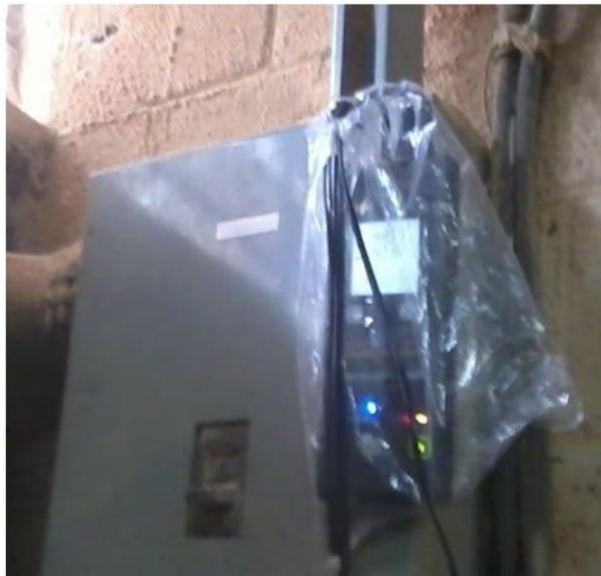
Figura 7. Registrador de energía colocado en acometida principal No. 1
