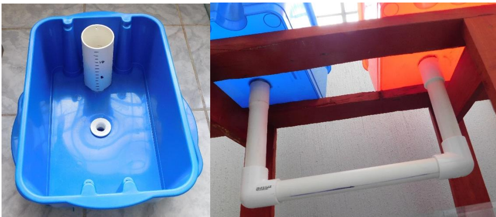
Figura 82. Contenedor con reductor y drenaje instalado
