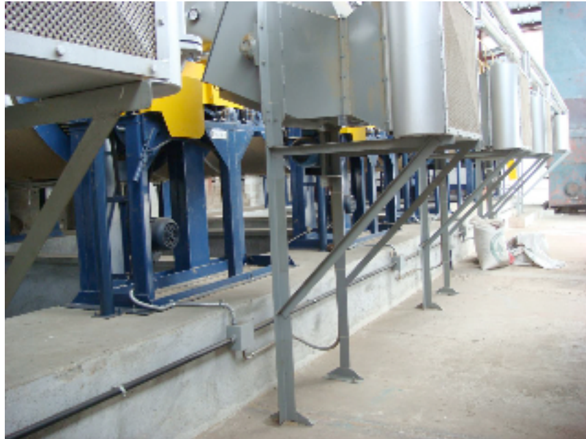
Figura 43 Estructura metálica para soporte de ventilador e intercambiador de calor
