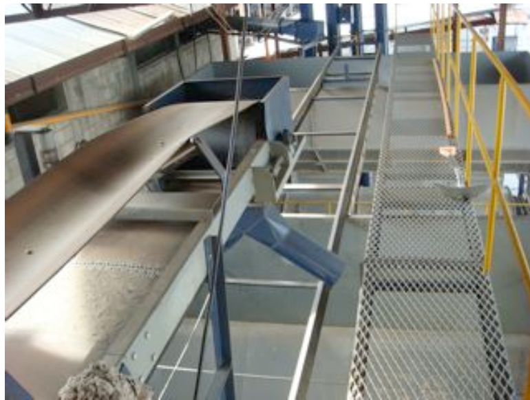
Figura 34 Distribuidores de bandas transportadoras
