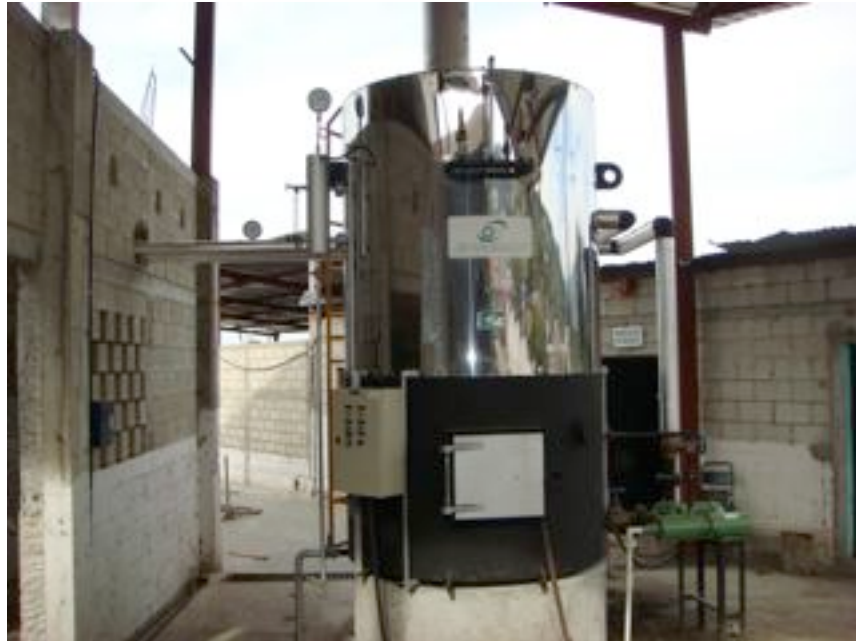
Figura 27 Caldera pirotubular marca ENGEMAN
