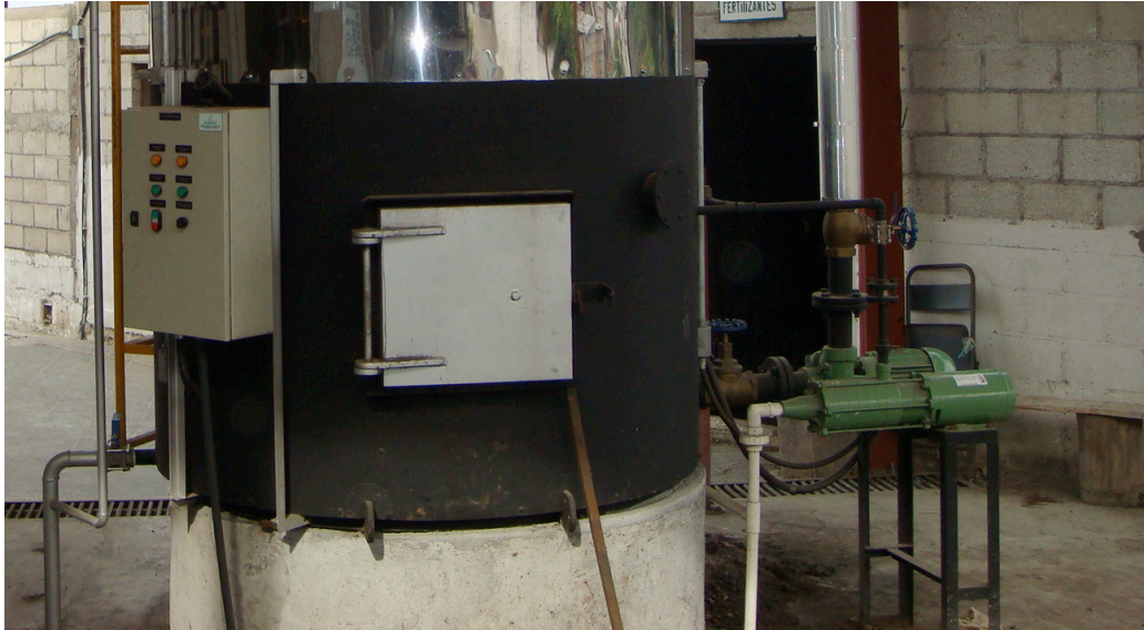
Figura 45 Bombas de recirculación
