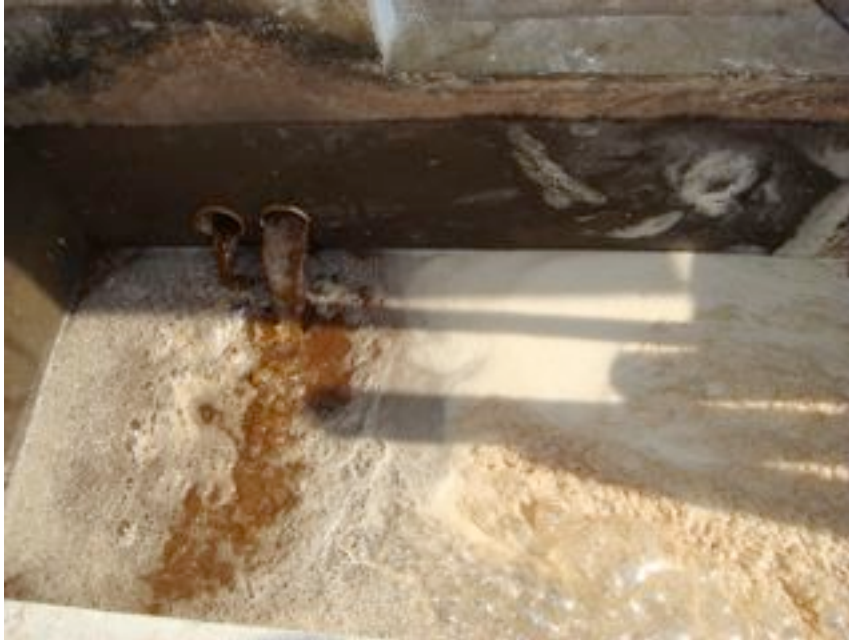
Figura 14 Decantador de agua de despulpado
