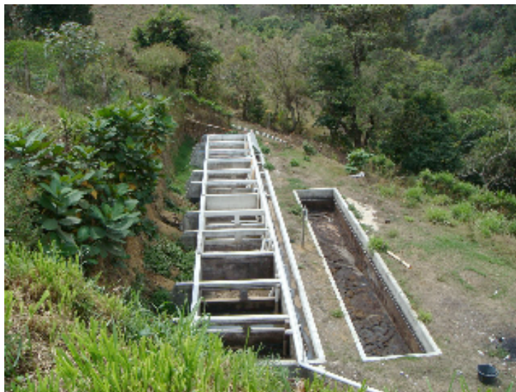
Figura 24 Planta de tratamiento de aguas residuales
