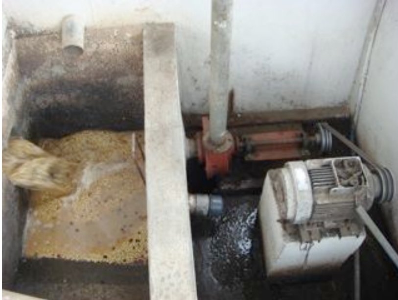
Figura18 Bomba de lavado
