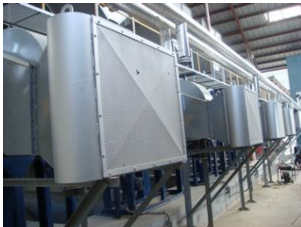
Figura 29 Radiadores conectados al sistema térmico
