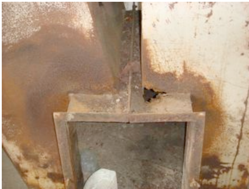
Figura 21 Hornos dañados por altas temperaturas
