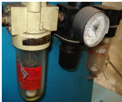
Unidad de mantenimiento de la red neumática en mal estado
