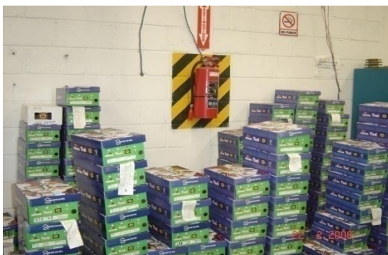
Extintor obstruido en área de empaque
