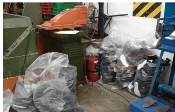
Extintor obstruido y fuera de ubicación
