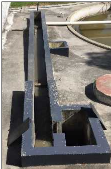
Figura 7. Vista general de las unidades que componen el pretratamiento de la PTAR (cámara de ingreso, rejillas, canal desarenador y fosa)
