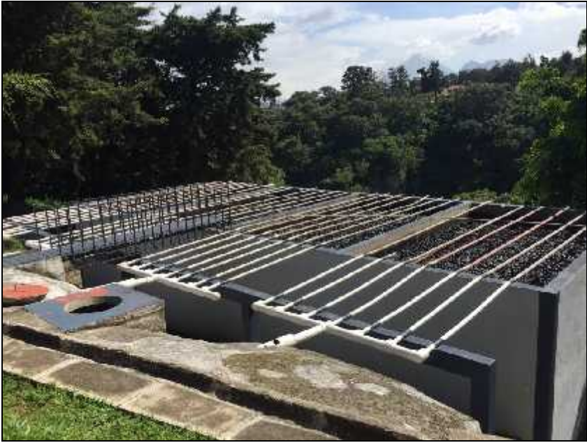
Fuente: Planta de tratamiento de aguas residuales, USAC.
