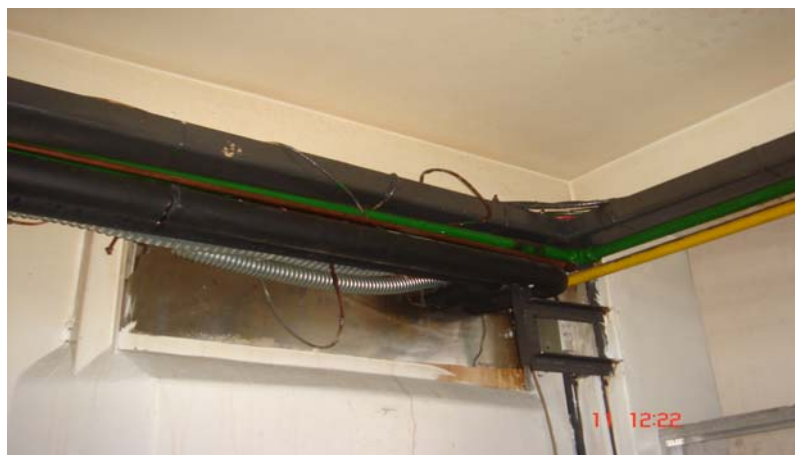
Figura 30. Instalación eléctrica hacia hornos
