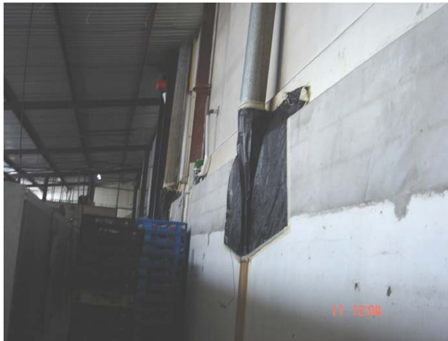
Figura 42. Chimeneas con fugas de agua
