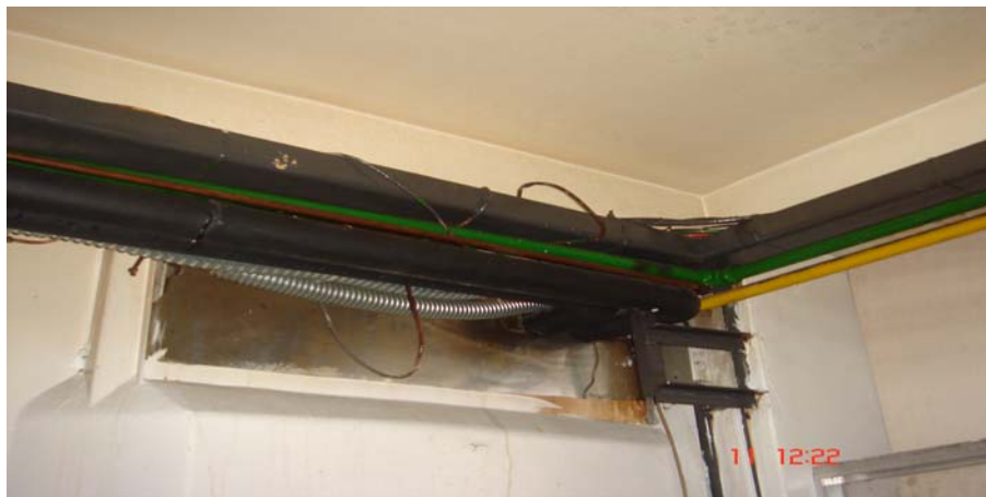
Figura 41. Canaleta de red de cableado eléctrico
