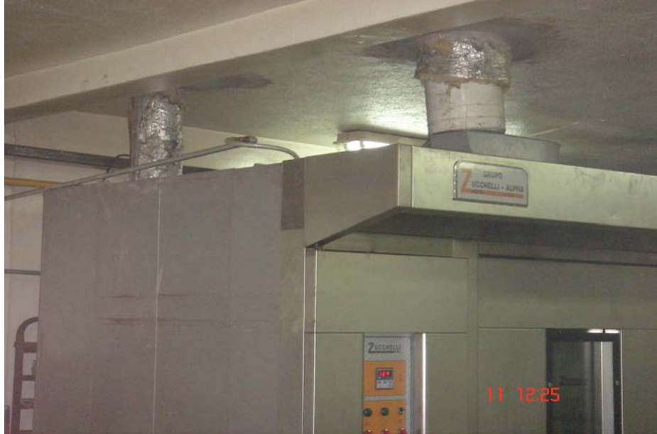
Figura 35. Falta de espacio entre hornos y techo
