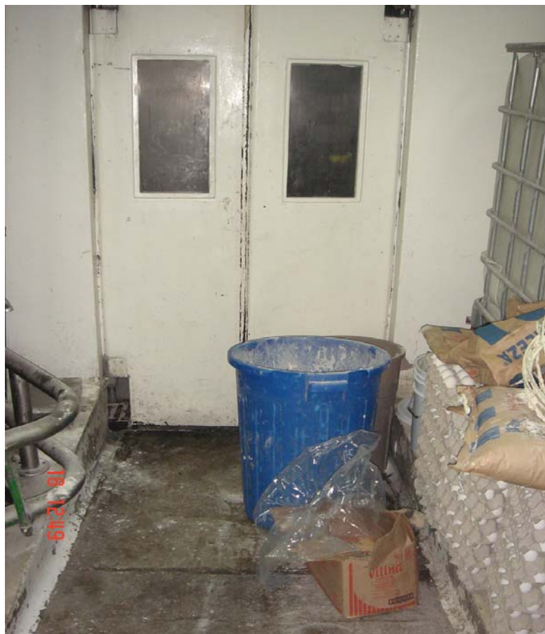
Figura 44. Salida de emergencias obstruida
