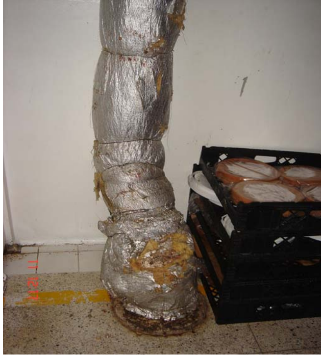
Figura 43. Chimeneas con aislante en mal estado
