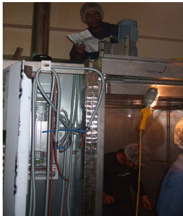
Figura 14. Instalación eléctrica hornos Werner.
