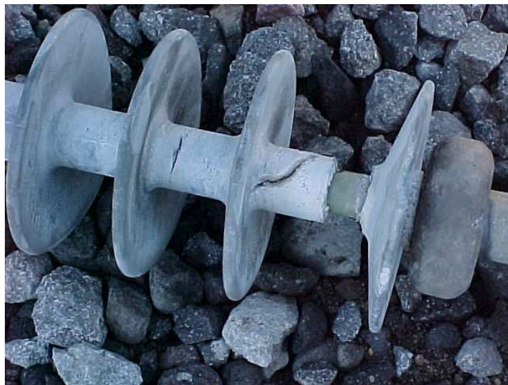
Figura 43. Rotura de aislador
