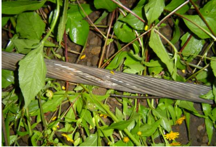
Figura 42. Conductor deshilado enviado al fabricante
