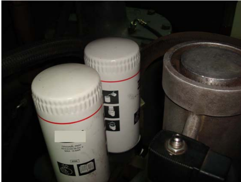
Figura 52. Filtros de aceite instalados en un compresor
