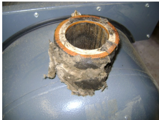
Figura 49. Filtro de aire completamente contaminado
