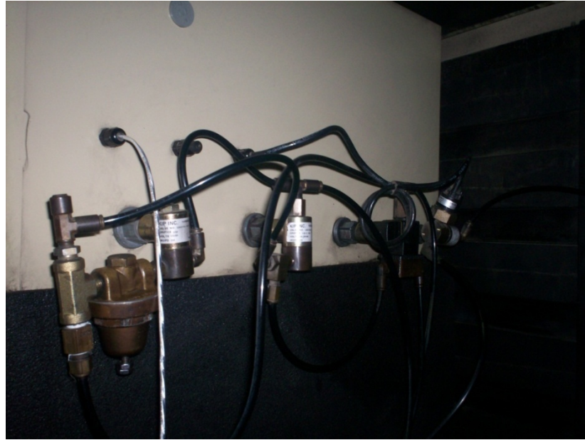
Figura 42. Vista de las válvulas de control con sus distintas señales de aire (diseño americano)
