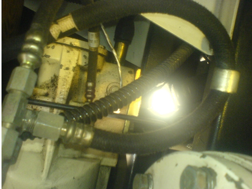
Figura 38. Mangueras dentro de un compresor
