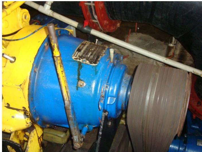
Figura 6. Embrague de la estación de bombeo
