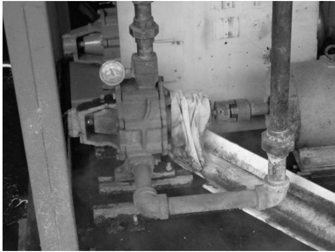
Figura 32. Situación actual de los manómetros
