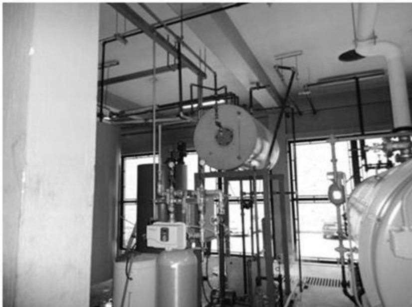
Figura 24. Tanque de alimentación de agua a la caldera
