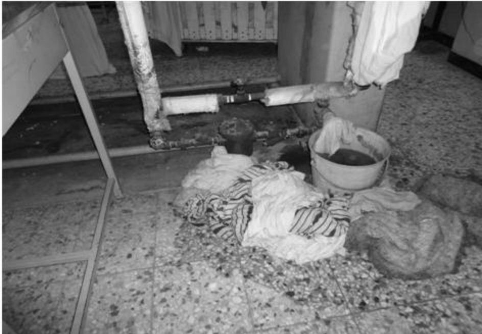
Figura 28. Situación actual de llave de paso
