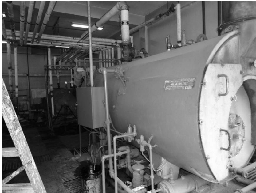
Figura 25. Sistema de alimentación de la caldera
