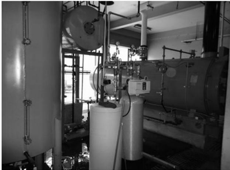
Figura 26. Sistema de abastecimiento de combustible
