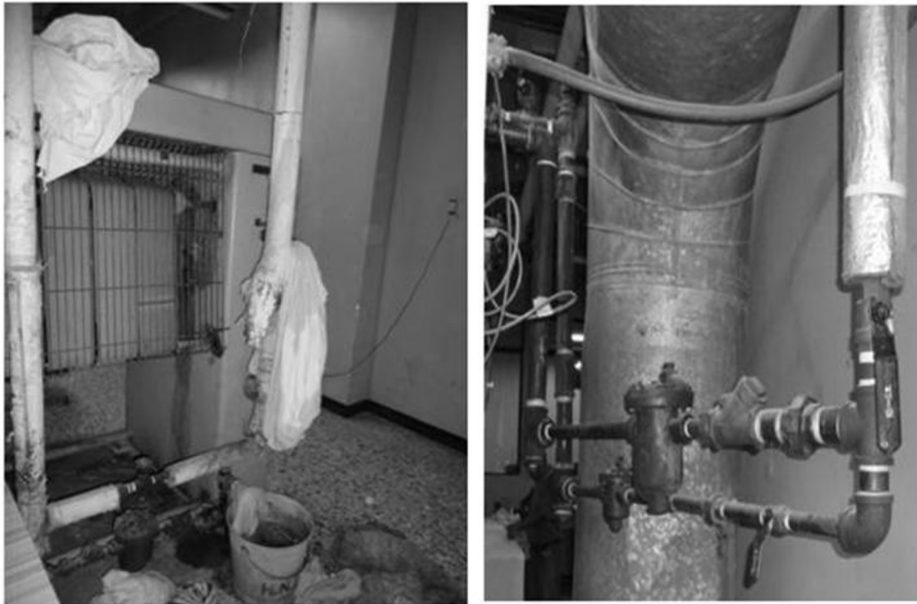
Figura 27. Situación actual de las trampas de vapor
