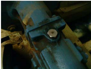
Figura 26. Punto de aplicación de lubricante a caja reductora
