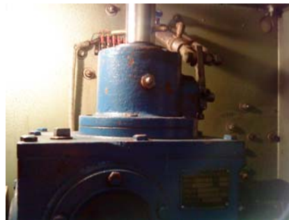
Figura 32: Punto de aplicación de grasa en caja reductora
