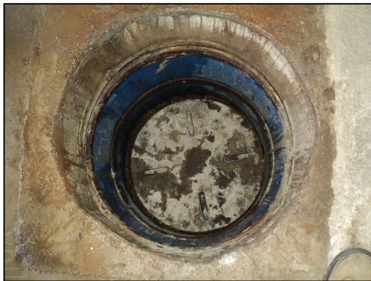
Figura 2. Fosa séptica para aguas residuales de cafetería
