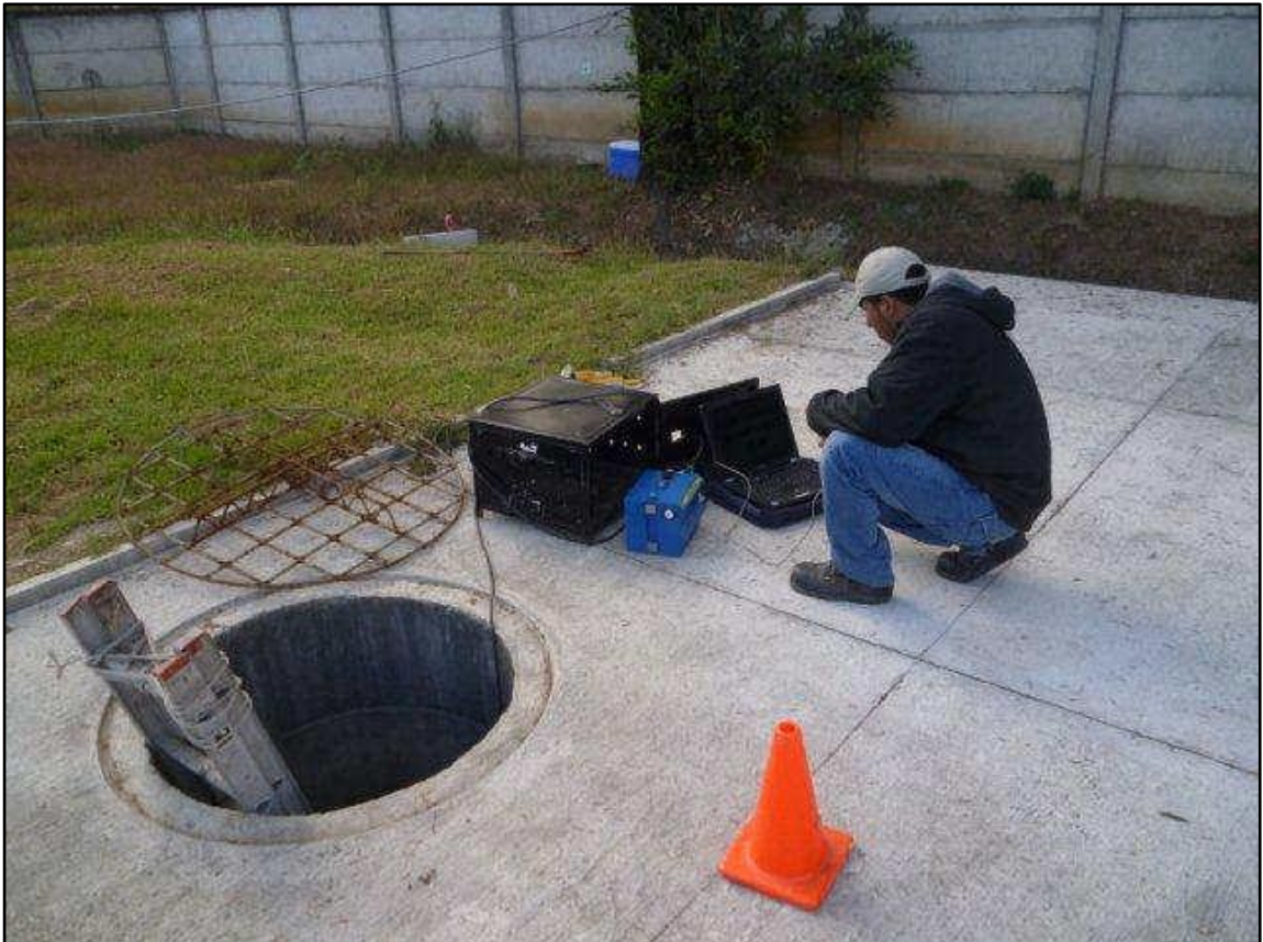
Figura 11. Pozo de absorción al final de proceso de tratamiento de aguas especiales
