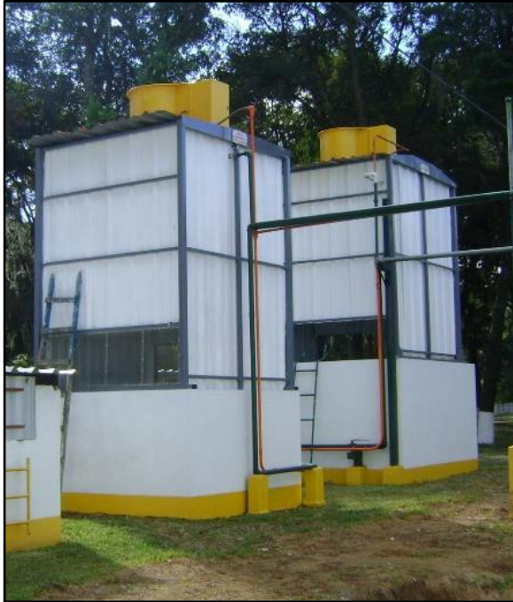
Figura 4. Torres de enfriamiento
