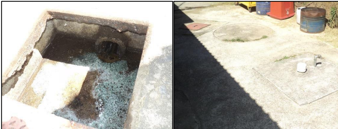
Figura 3. Fosa séptica para aguas residuales de garita
