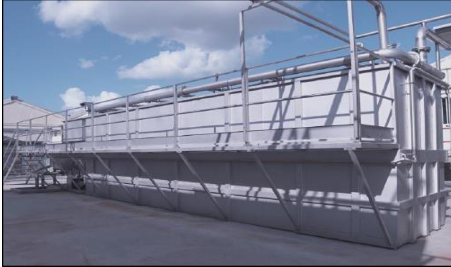
Figura 22. Módulo de tratamiento
