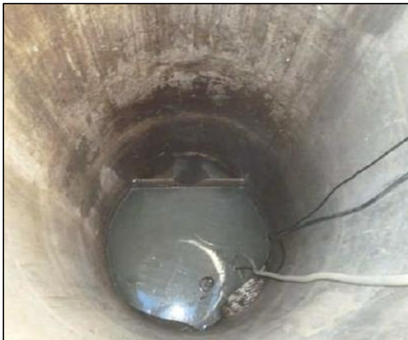
Figura 10. Pozo de visita del punto de muestreo de aguas residuales especiales
