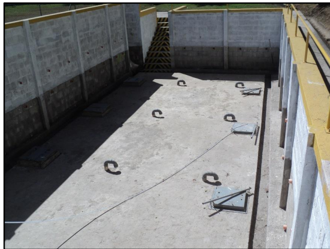
Figura 9. Unidad de tratamiento de aguas especiales
