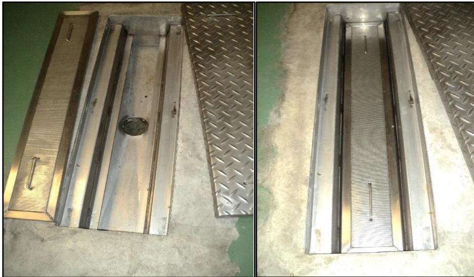
Figura 8. Drenajes de fábrica
