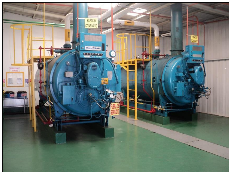
Figura 5. Cuarto de calderas
