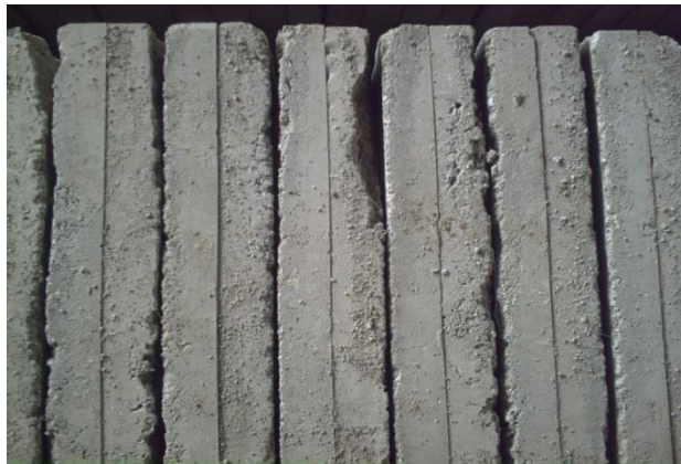
Figura 38. Imagen de piezas de piso en mal estado
