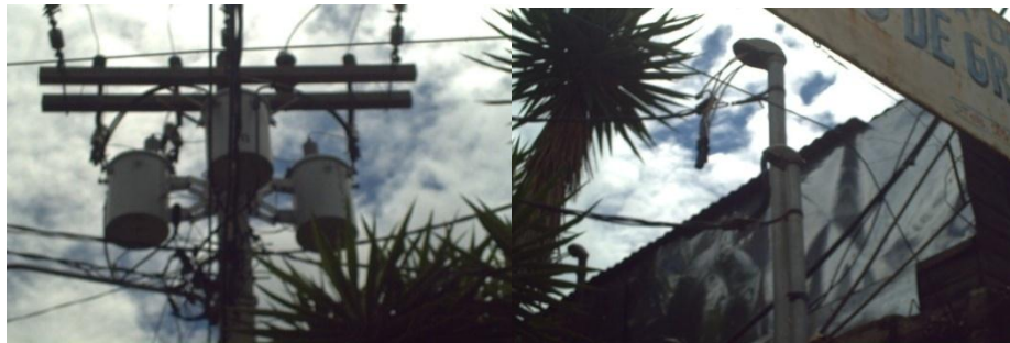
Figura 27. Banco de transformadores de distribución trifásica localizados en los linderos de la empresa
