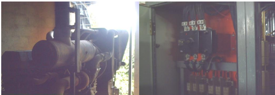
Figura 26. Planta generadora de energía eléctrica ubicada en el área de generación colindante con la planta de producción
