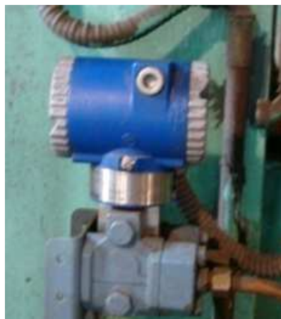
Figura 13. Medidor de presión del hogar, gases de salida
