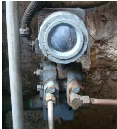
Figura 11. Medidor de presión de aire de combustión (tiro forzado)
