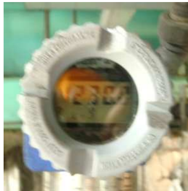
Figura 8. Medidor de presión del agua de alimentación de la caldera
