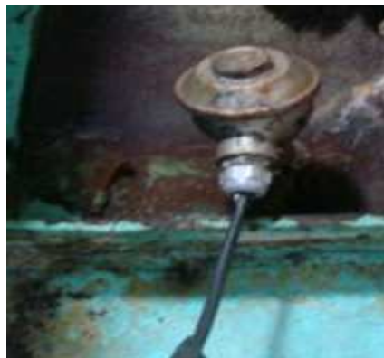
Figura 12. Medidor de temperatura de gases de salida de la chimenea de la caldera
