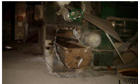
Figura 38. Artesa (canao) del transportador helicoidal instalado en el cenicero de la caldera
