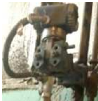
Figura 7. Medidor de flujo de agua de alimentación
