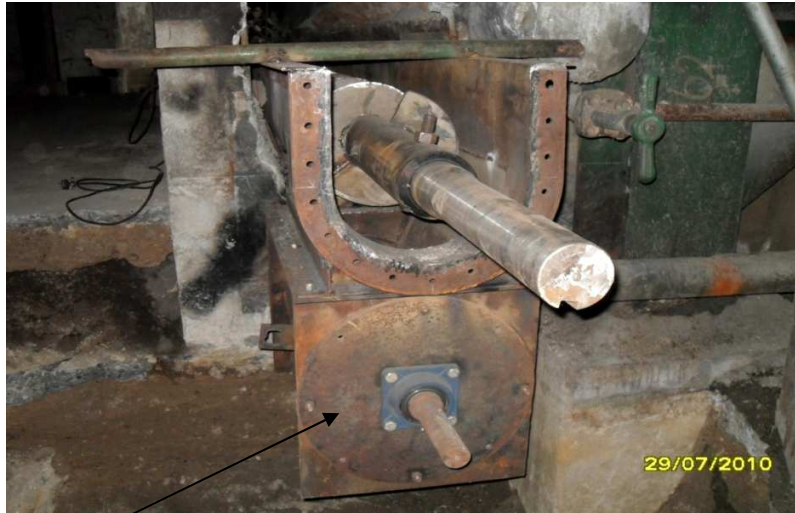
Figura 39. Artesa (canao), transportador helicoidal y sello instalado en el cenicero de la caldera
