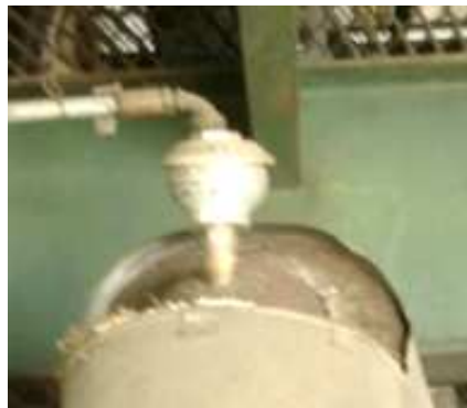
Figura 9. Medidor de temperatura del agua de alimentación
