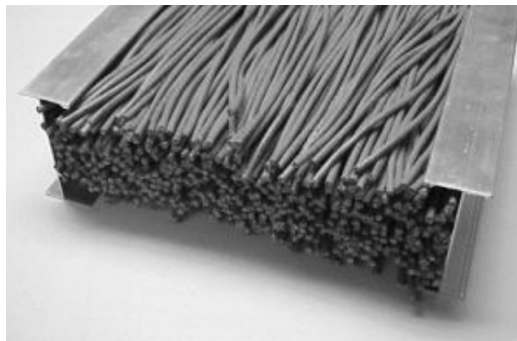
Figura 31. Canaleta con cableado calculado al 50 % de su capacidad
