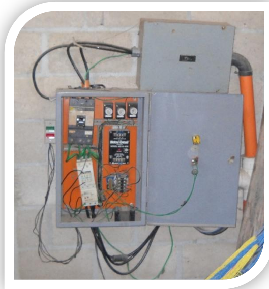
Figura 9. Conexiones eléctricas equipo de bombeo
