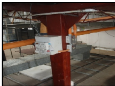
Figura 22. Tablero eléctrico y tubería eléctrica
