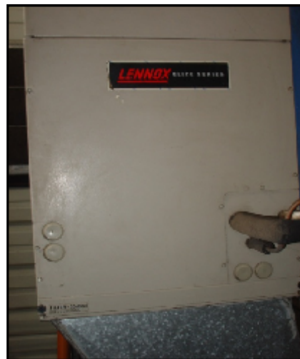
Figura 36. Condensadora de aire
