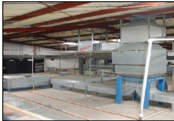
Figura 42. Muestra de los ductos a limpiarse
