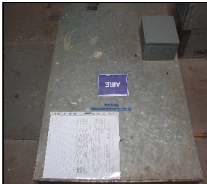
Figura 43. Ubicación de hoja de registro de limpieza y desinfección de UMA en cada gabinete
