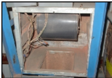
Figura 17. Ventilador extractor de aire viciado
