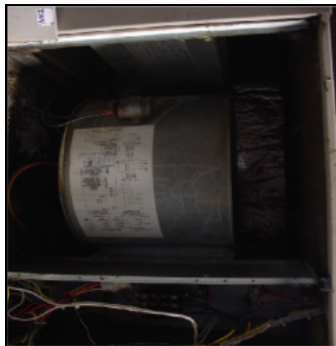
Figura 35. Motor del ventilador con serpentín
