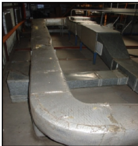
Figura 37. Gabinetes y ductos con fibra de vidrio
