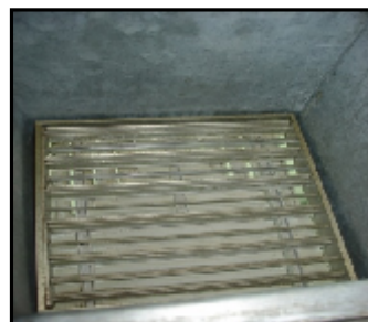
Figura 33. Difusor de inyección de aire de área estéril
