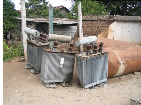
Figura 79. Equipos vaciados, en Subestación La Fragua, Zacapa,
