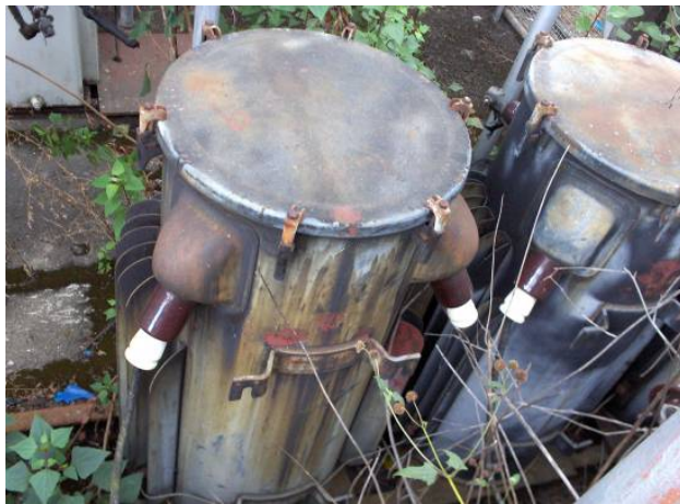
Figura 97. Transformadores susceptibles de contener PCB en FEGUA zona 1.
