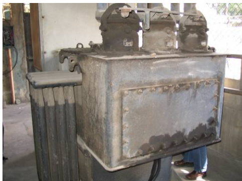
Figura 100. Transformador instalado en los 50's, en CONFEDE
