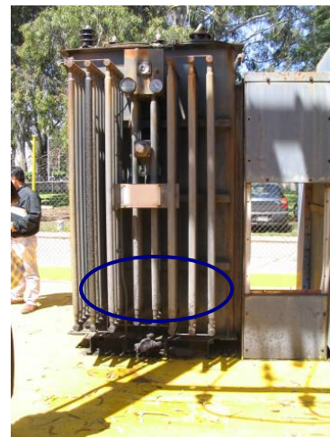
Figura 96. Equipo en desuso y con fuga, en Hospital Roosevelt.
