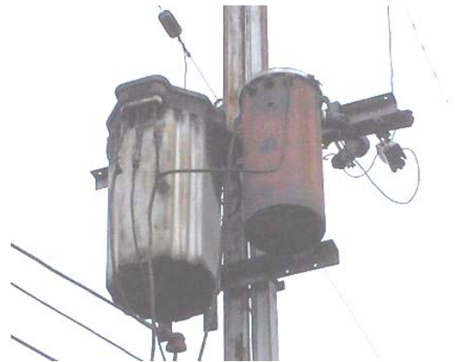
Figura 32. Equipos antiguos sin información del dieléctrico.
