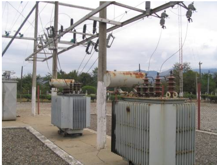
Figura 78. Equipos antiguos en la subestación de La Fragua.
