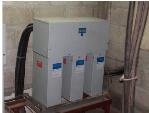
Figura 19. Celdas Monofásicas para alta tensión.
