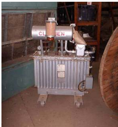
Figura 4. transformador trifasico fabricado con PCB
