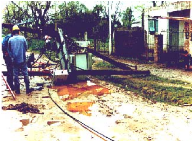
Figura 11. Transformador caído en Derqui, Provincia de Buenos Aires, el 3 de Octubre del 2000.
