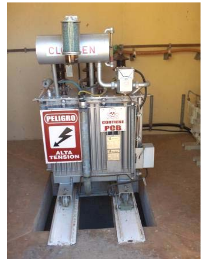
Figura 77. Equipo con PCB en Aguacapa
