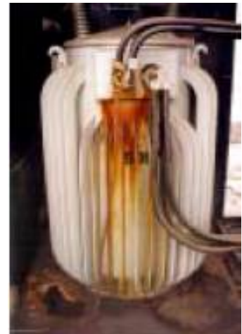
Figura 12. Transformador con fuga, "accidente frío".
