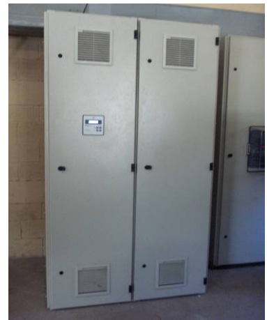
Figura 18. Banco de Capacitores en Gabinete.
