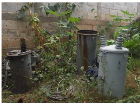
Figura 91. Condiciones de almacenaje en EEM de Guastatoya, El Progreso.
