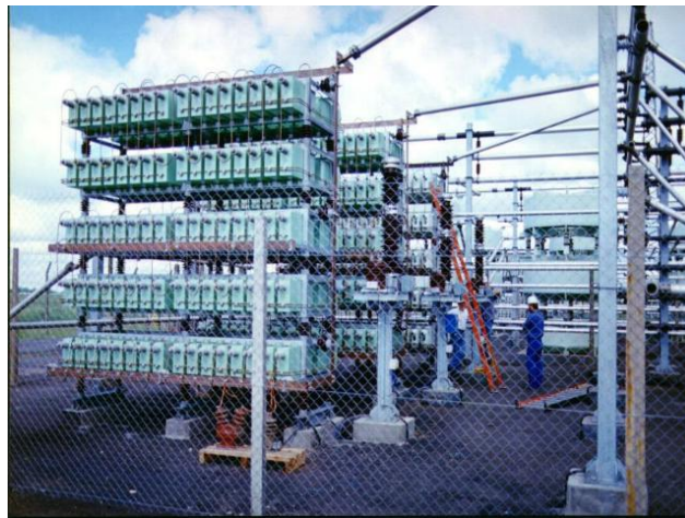
Figura 16. Bancos de capacitores de Potencia sobre Bastidores Metálicos.
