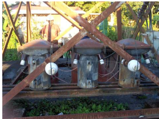
Figura 98. Transformadores antiguos inventariados en FEGUA, Puerto Barrios.
