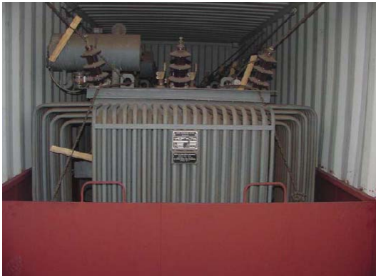
Figura 49. Manera de colocar un trafo con PCB dentro de contenedores para transporte.
