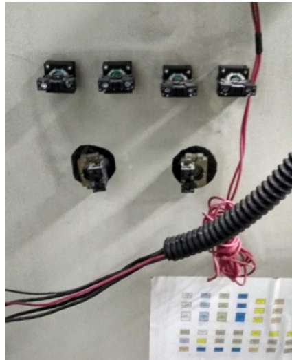
Figura 18. Indicadores y pulsadores de emergencia (vista trasera)
