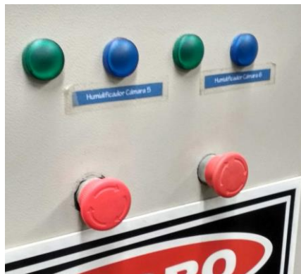
Figura 17. Indicadores y pulsadores de emergencia (vista frontal)
