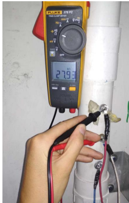
Figura 35. Medición del sensor de nivel del barril (sin agua)
