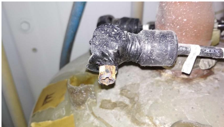
Figura 33. Corrosión en conectores de alimentación de electrodos
