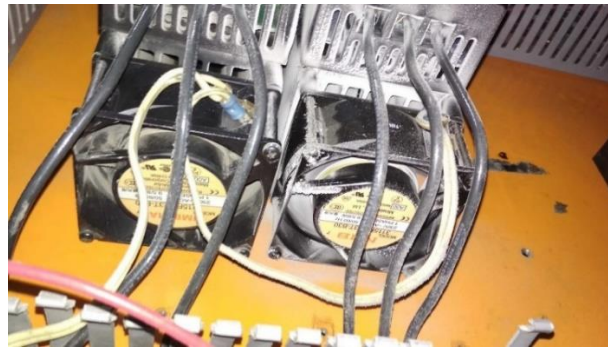
Figura 25. Ventiladores de controladores de potencia dañados (panel cámara 1)
