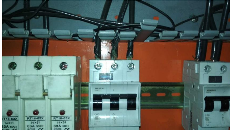
Figura 23. Cables de breakers dañados
