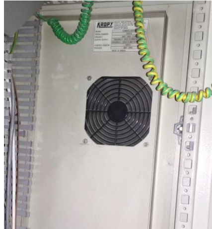
Figura 14. Falta de ventilador
