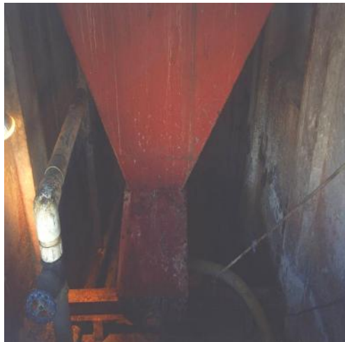
Figura 33. Tubería de agitación
