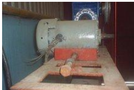
Figura 20. Motor eléctrico de separador de sólidos
