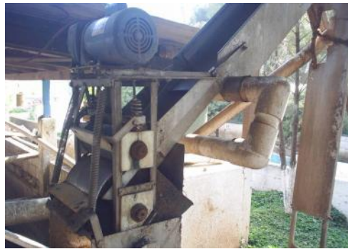
Figura 8. Separador de sólidos por filtración-compresión
