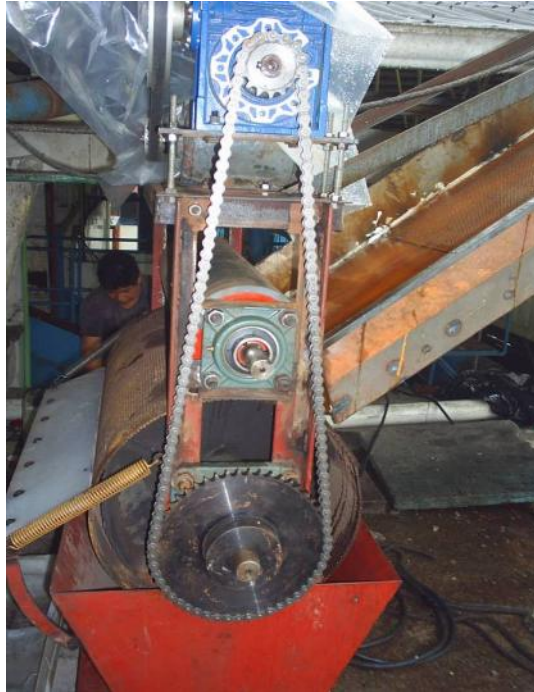
Figura 24. Cadena de transmisión de potencia en separador de sólidos
