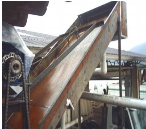
Figura 28. Canal (criba de filtración) de separador de sólidos
