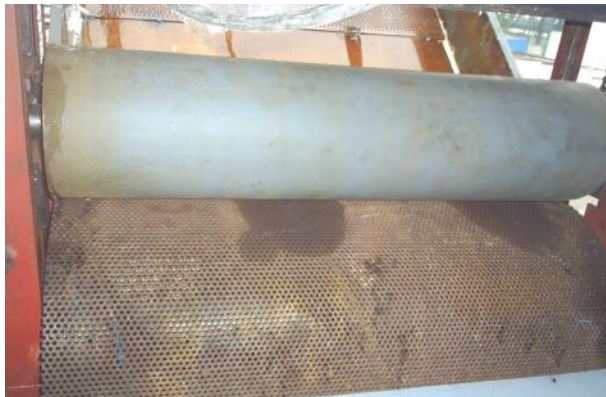
Figura 26. Rodillo de caucho de separador de sólidos
