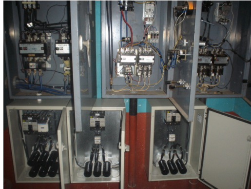
Figura 24. Banco de capacitor fijo de 10 Kvar, 480 voltios
