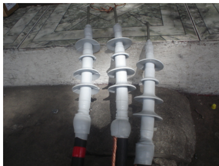
Figura 52. Terminaciones nuevas 13.2 kilovoltios
