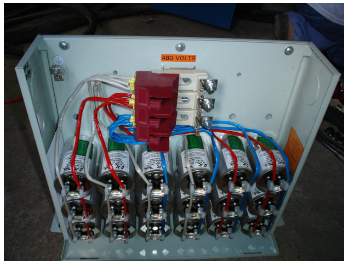
Figura 3. Banco de capacitores instalado en el pozo TP-2
