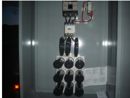
Figura 27. Banco de capacitores semi - automático de 35 Kvar, 480 voltios
