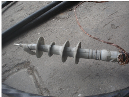
Figura 51. Terminaciones antiguas 13.2 kilovoltios
