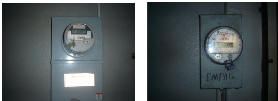
Figura 49. Medidores de energía eléctrica antiguos
