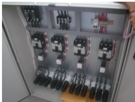
Figura 25. Banco de capacitores automático de 50 Kvar, 480 voltios
