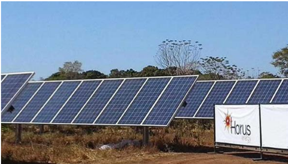
Figura 1. Planta solar fotovoltaica – Horus Guatemala
