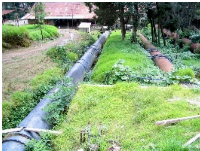
Figura 13. Tubería de presión
