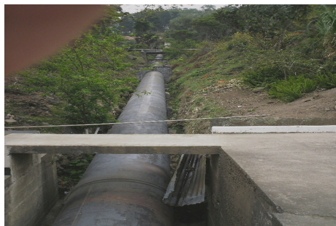
Figura 15. Final de la tubería de presión
