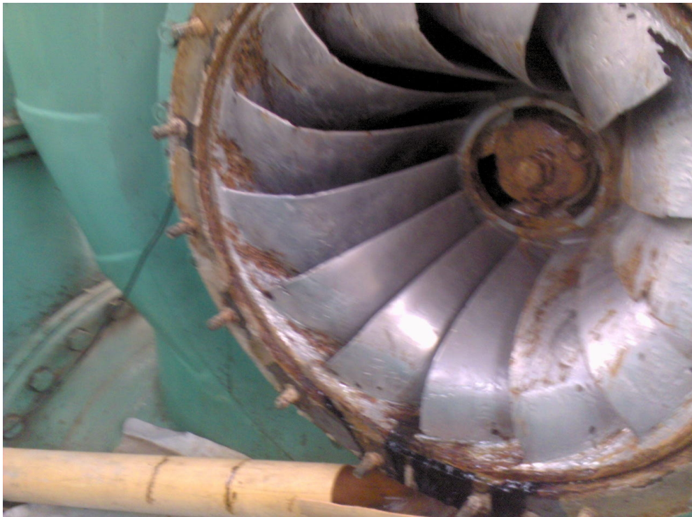
Grado de desgaste del rodete de la turbina tipo Francis
