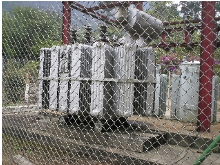
Figura 28. Antiguo banco de transformación
