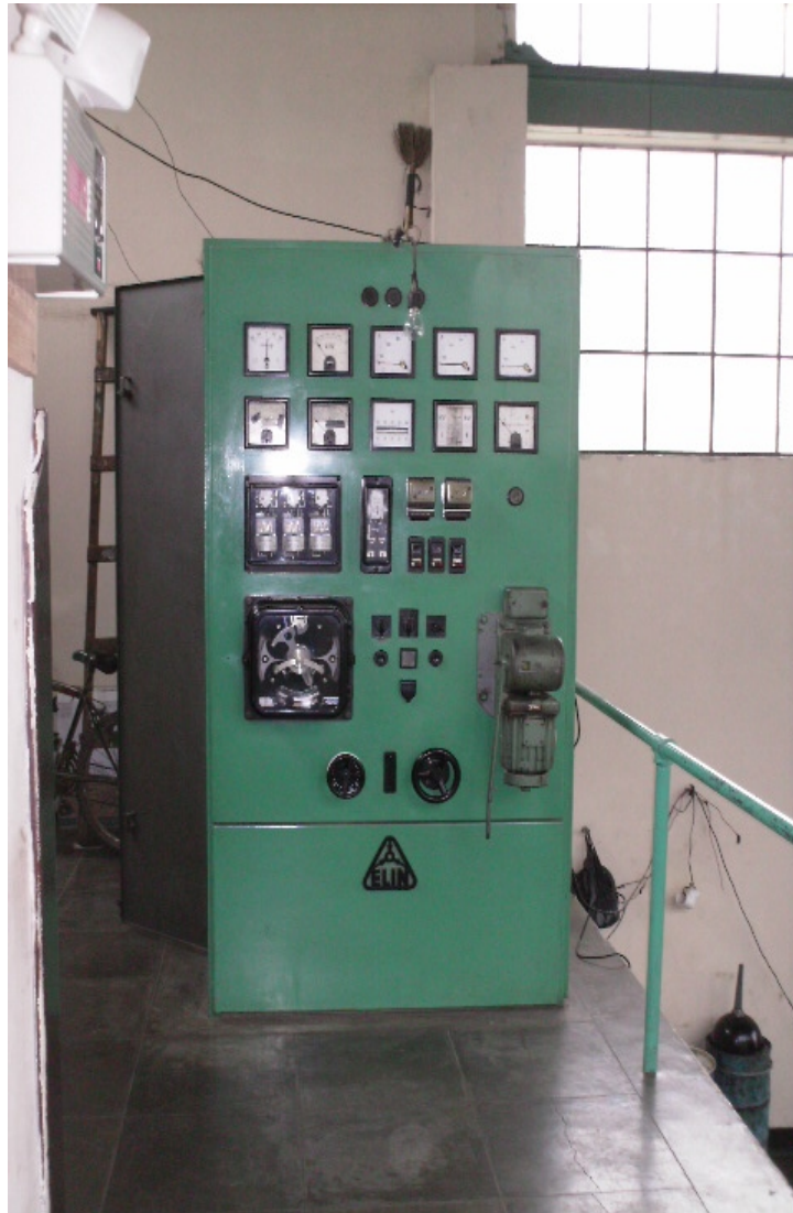
Figura 25. Tablero del generador
