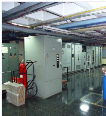
Figura 9. Estación de rectificación, monitoreo y dispositivos de arranque
