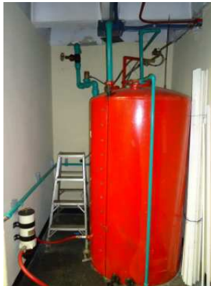
Figura 5. Tanque auxiliar de diesel
